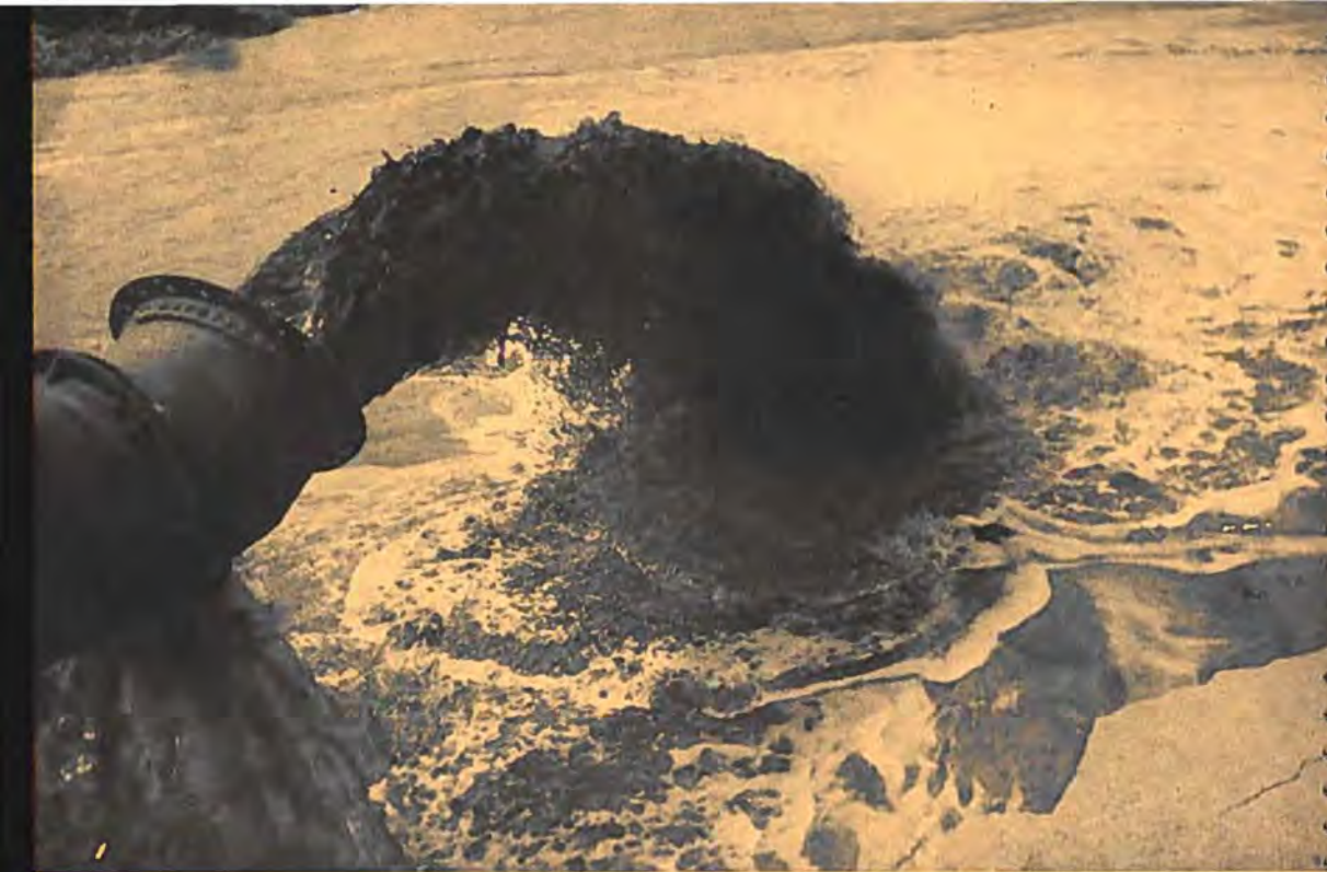
De zandzuiger en de perswerktuigen zijn onontbeerlijke hulpmiddelen bij elke dijksdichting. Door een lange persleiding wordt een mengsel van zand en water in het gat gespoten. Het water vloeit weg; het zand bezinkt.
