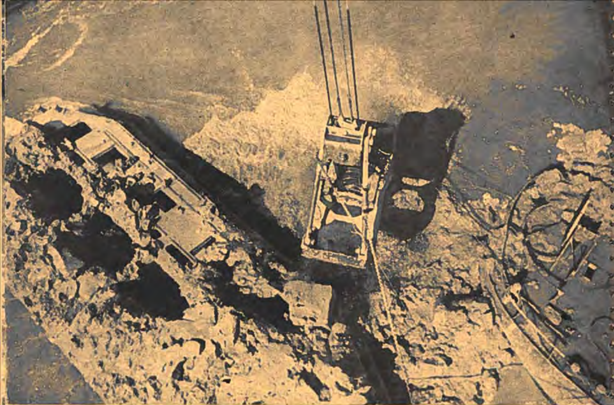
Nollegat, 2 September 1945: dichting van de voorlaatste geul, tusschen een met klei geballaste betonnen caisson („beetle“) en de achterstevan van een Duitsch invasieschip, dat in het gat tot zinken werd gebracht, waarna het volgeplempt werd met klei.
