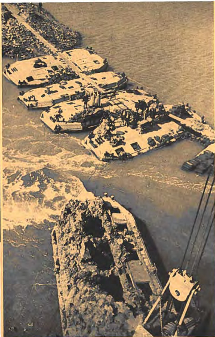
2 September 1945: Foto genomen vanuit de top van den kraanarm, bij de eerste sluiting van het Nollegat. Midden in de foto de sluitgeul, die in den nacht van 2 op 3 September gedicht werd.
