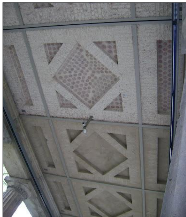
Figuur 5.4: Details plafond galerij Neues Museum. Boven de nieuw toegevoegde delen in metselwerk, onder de oude natuurstenen delen.
