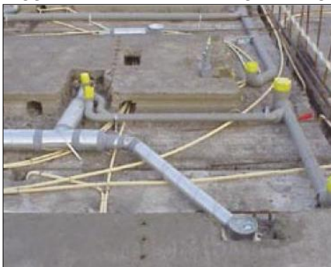
Figuur 64: oude wingvloer met leidingwerk in goot en ingekorte kop [Betonson] 41
