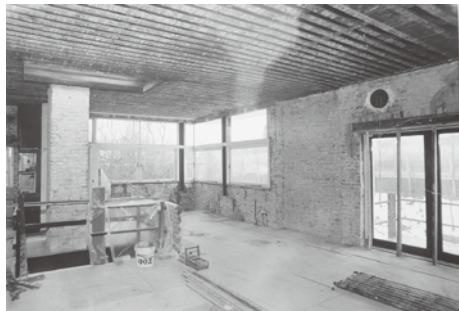
图 16: 室内墙壁和天花板被拆除表面后的样子
