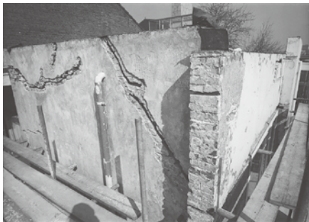
图 14: 墙面上有很深的裂痕
