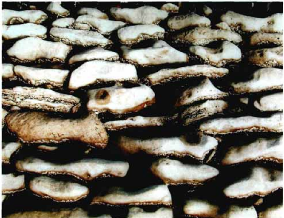
Foto 1.3 Oude bekleding van Vilvoordse steen
