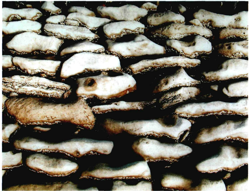
Foto 1.3 Oude bekleding van Vilvoordse steen
