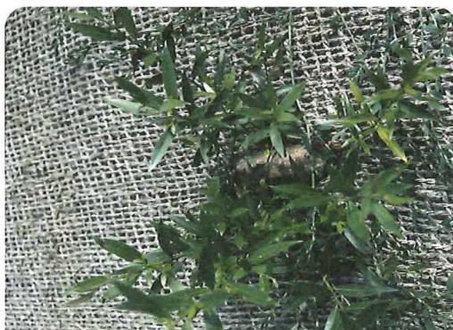
Bild 3.4.3.4: Detail zu Bild 3, Austrieb Steckholz 8 Wochen nach dem Einbau
