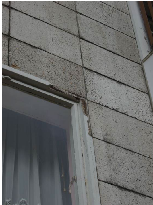
Fig. 4.4. Wapeningscorrosie aan het betonnen raamkader.
