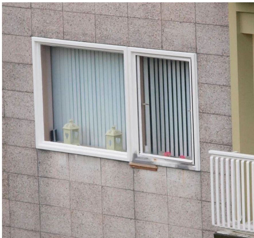
Fig. 2.83. De betonnen kaders rond de ramen zijn kwetsbaar en worden hersteld in 2009.
