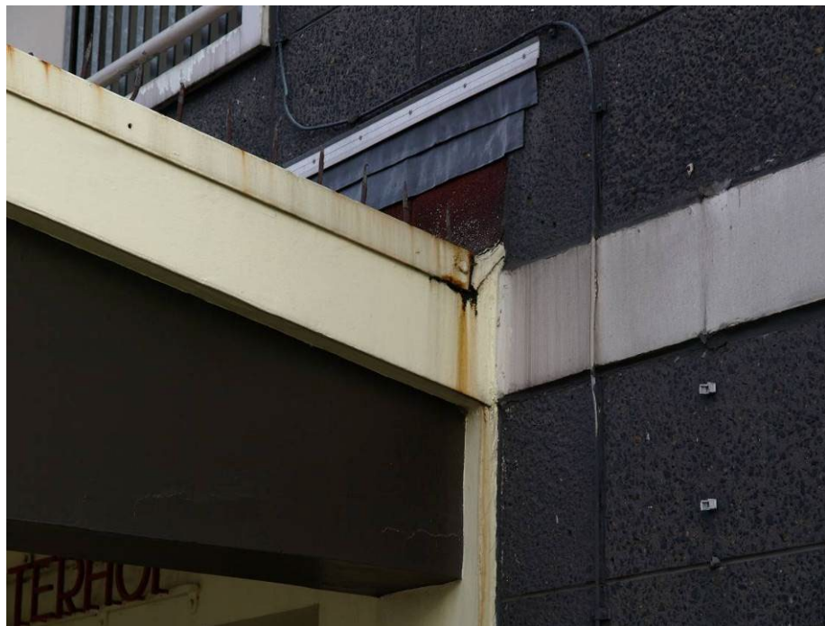
Fig. 2.86. Schotelantennes, schoorstenen en noodlijdende details vragen om onderhoud en beleid.
