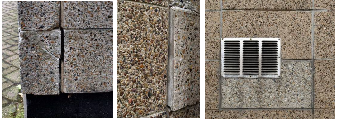
Fig. 2.127. Verschillende beschadigingen van de gevelpanelen.
