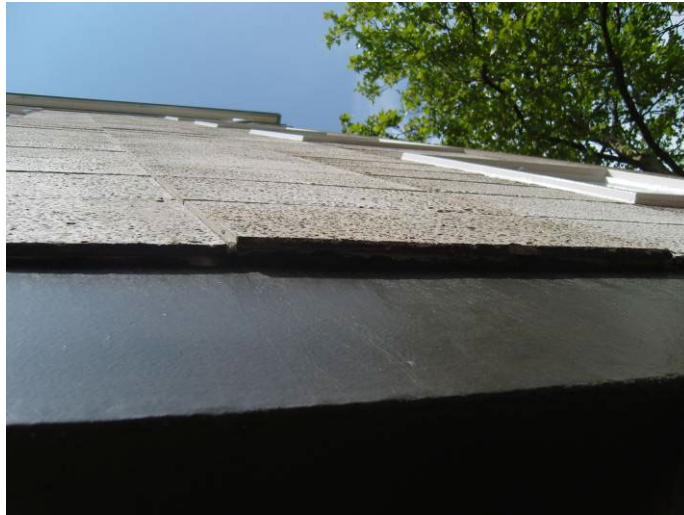
Fig. 4.9. Het onderste gevelpaneel is uit het vlak gekomen.
