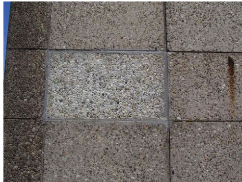
Fig. 5.3. Voorbeeld van een recent vervangen betonplaat met duidelijk van nature veel witter grind.
