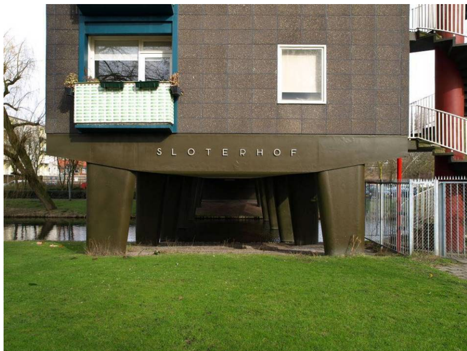
Fig. 2.90. De oorspronkelijke kleurstelling van lichte tinten op de betonnen elementen is veranderd.
