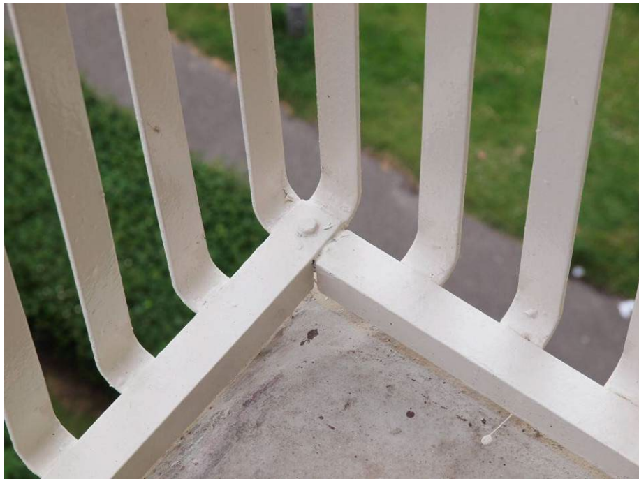
Fig. 2.94. In het detail toont zich de meester: betonnen raamkozijn en stalen balkonhekje.
