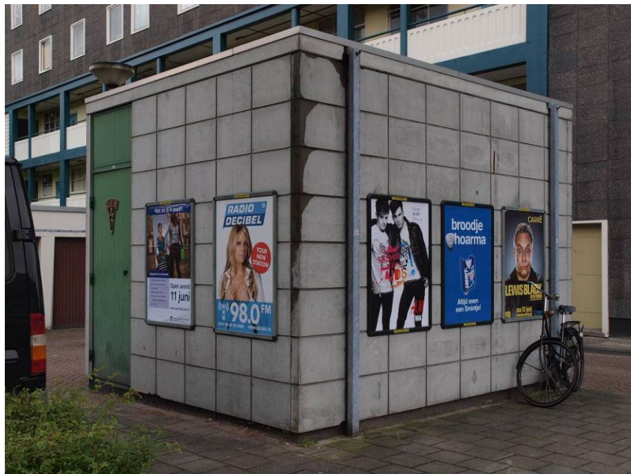
Fig. 2.81. Een oorspronkelijk trafostation in een blok garages en een vernieuwd exemplaar. De objecten zijn eigendom van het energiebedrijf.
