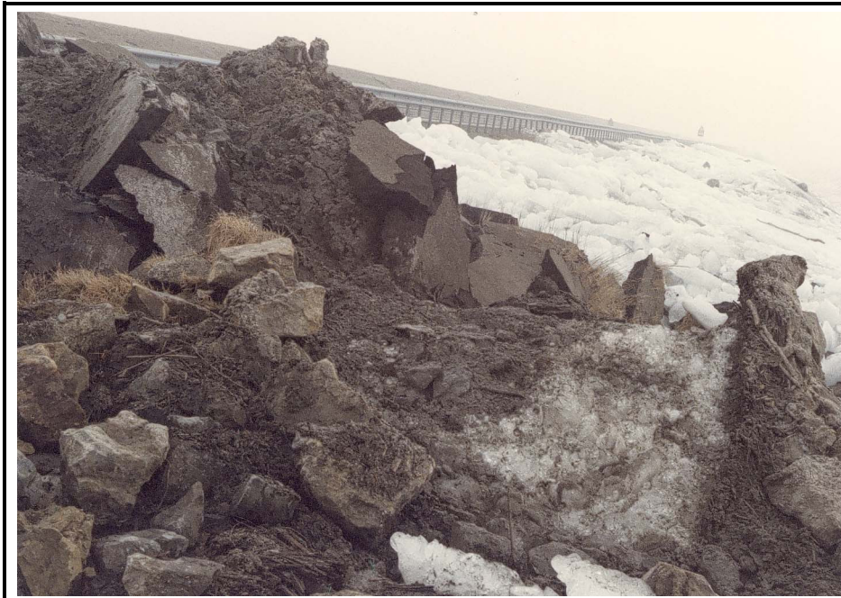
Figuur 6.2 Schade aan toplaag van een dijk door kruend ijs
