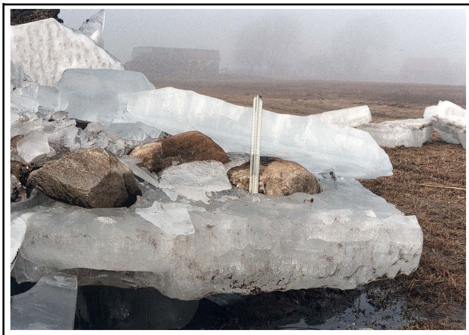
Figuur 5.1 Verplaatste stenen door ijs (IJsselmeerdijk bij Laaxum, Friesland)
