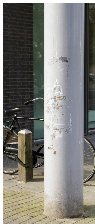
Figuur 35b Schade aan kolom
