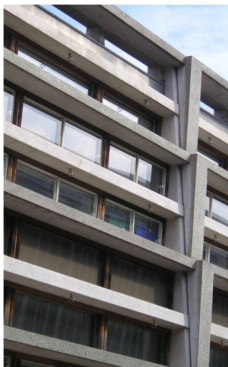
Figuur 45 Brise-soleils in gevelsysteem
