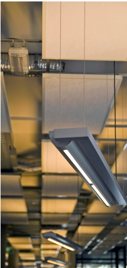
Figuur 38 Armaturen, baffles, installaties
