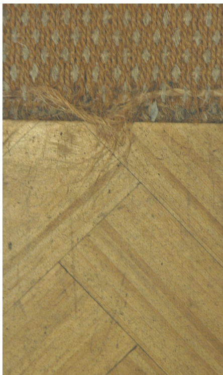
Figuur 72 Slijtage van de vloer
