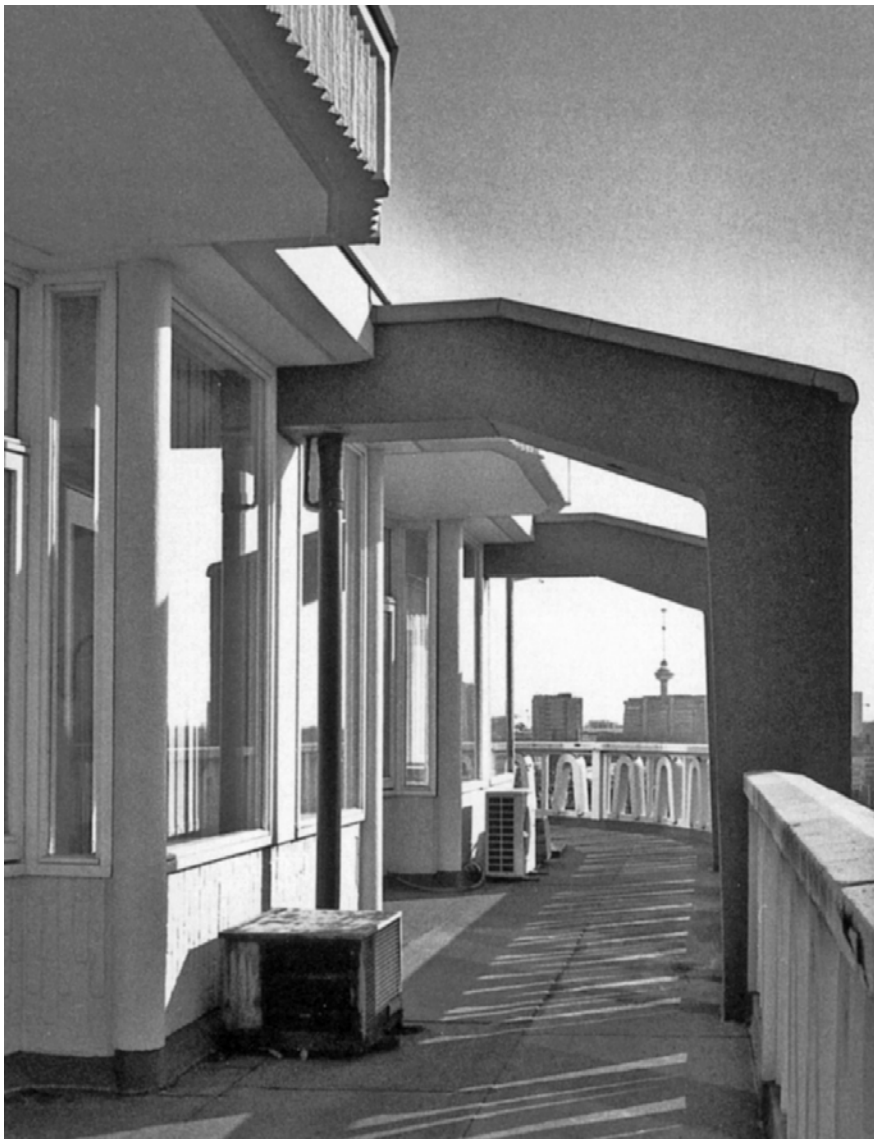
Afbeelding 4.2.163: de units van de airconditioning op de galerij van de bovenste verdieping. Vroegindewei, R. en C. Boekraad, Groothandelsgebouw 1948-2003 , Rotterdam 2003.
