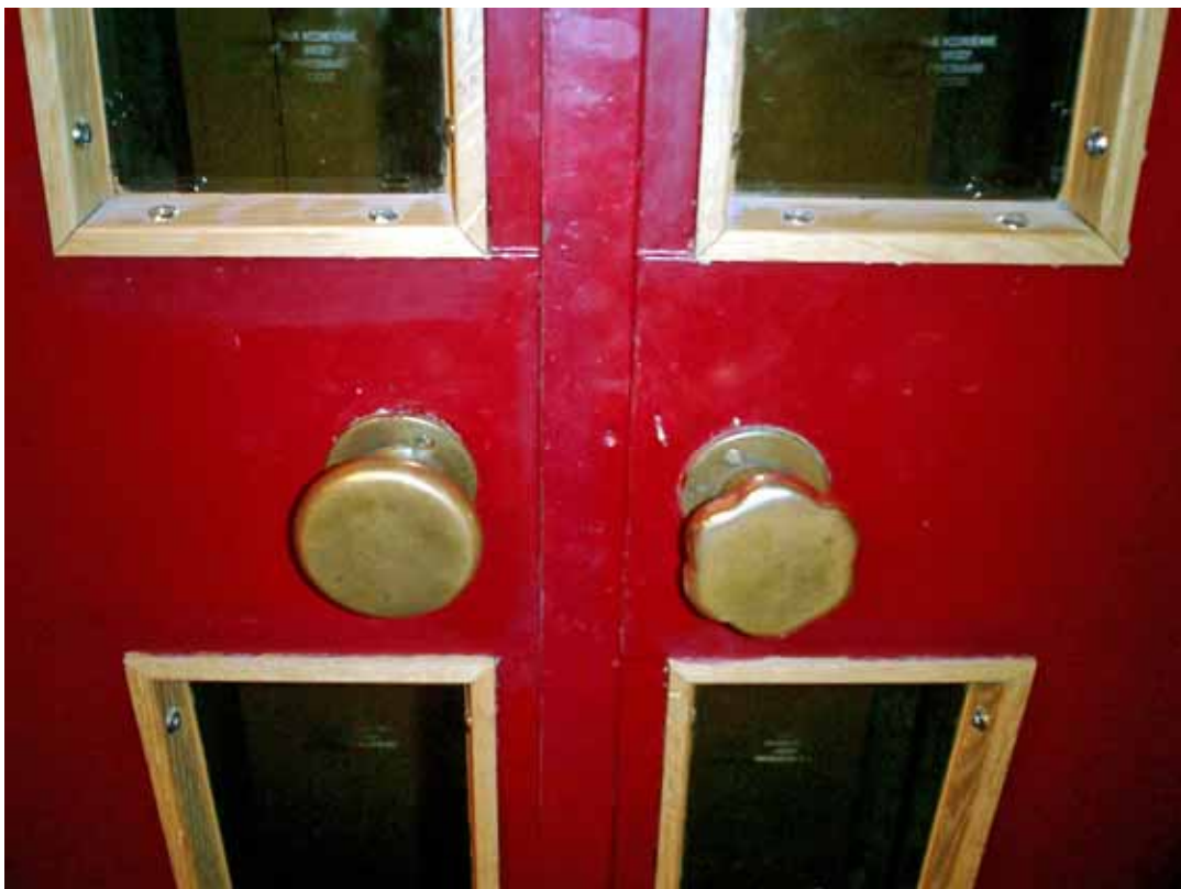
Afbeeldingen 4.2.201 en 202: de knoppen (rond = duwen, gekarteld = draaien) op de liftdeuren overleefden de regeneratie, de kleur en glaslatten niet. H. Zijlstra 2002 en 2004.
