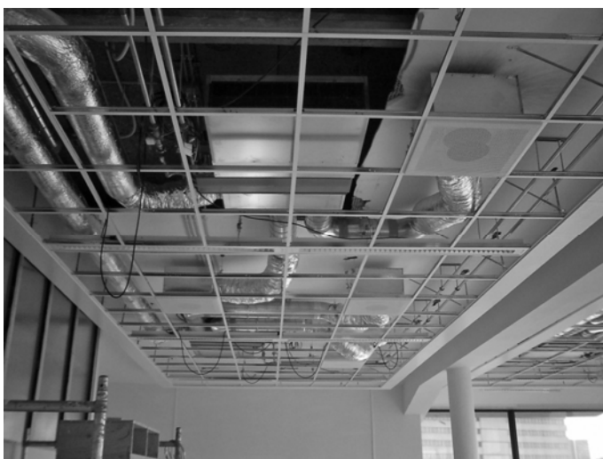
Afbeelding 4.2.193: de plafonds met de installatievoorzieningen. H. Zijlstra 2004.
