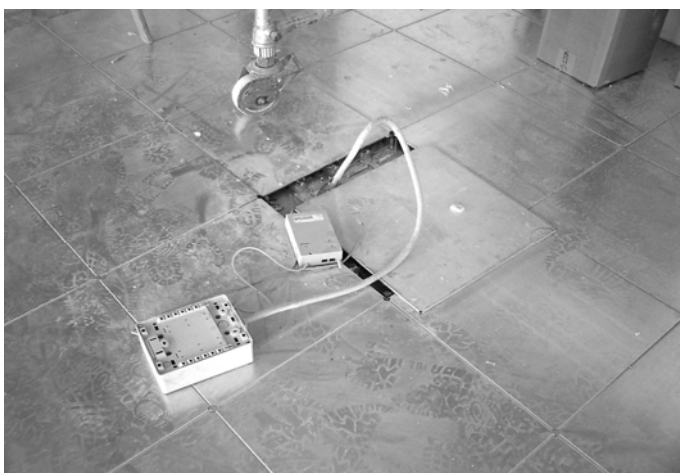
Afbeelding 4.2.191: de verhoogde vloeren met installatievoorzieningen. H. Zijlstra 2004.
