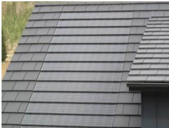
FIGURE 58: PV PANELS IN FORM OF ROOF FILES (ZONNEPANEELWIJZER, 2014)
