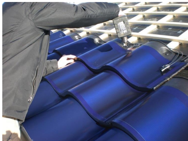
FIGURE 59: PV PANELS IN FORM OF ROOF FILES (ZONNEPANEELWIJZER, 2014)
