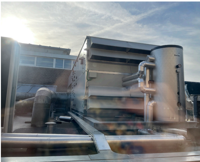
Figuur 5.4 - Vernieuwde LBK op het dak uit het zicht vanaf de straat
