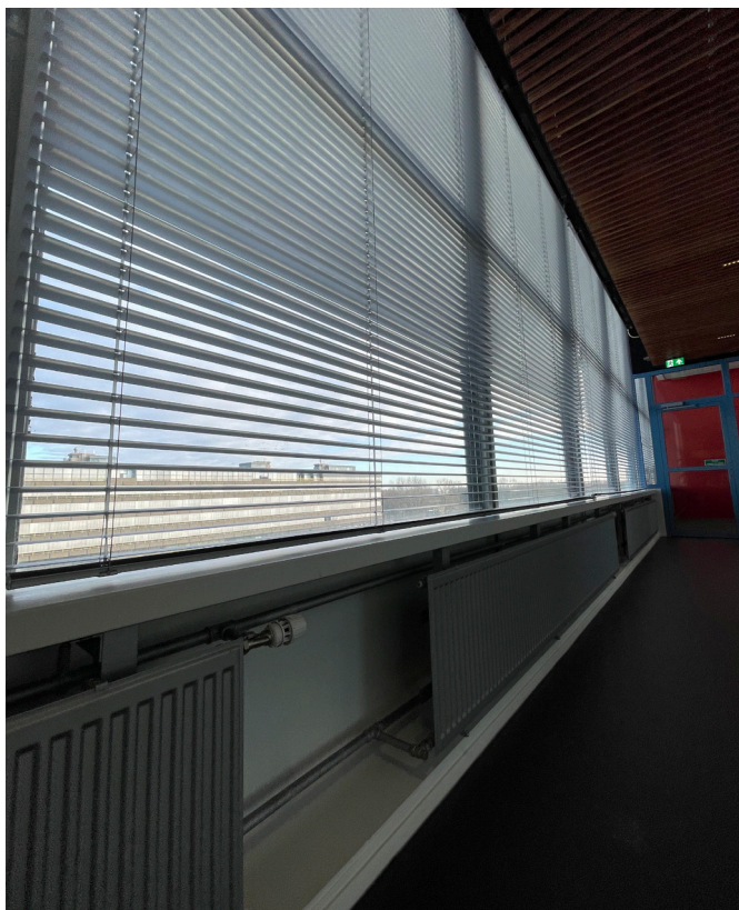
Figuur 2.3 - Uiterste deel gebouw zicht op ongeïsoleerde gevelpanelen
