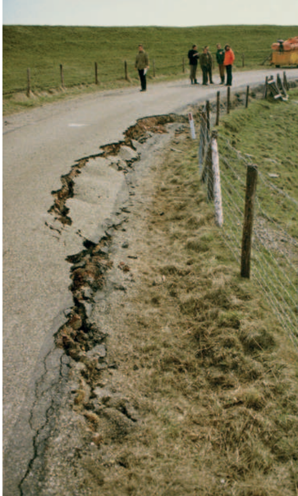
Figure 1. Failure of dike in North Holland, polder Beschoot (Photo courtesy Beeldbank Rijkswaterstaat beeldbank, Hein Versteeg).
