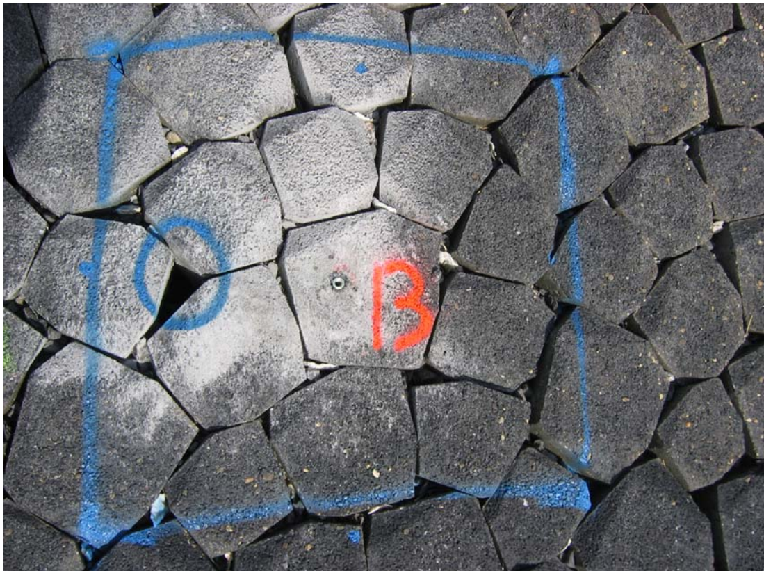
Figuur 6-16 Voorbeeld in Sluis van een vak waarin de inwassingsbeoordeling is uitgevoerd. Geheel leeggespoelde gaten zijn blauw omcirkeld (hier is slechts één cirkel zichtbaar)
