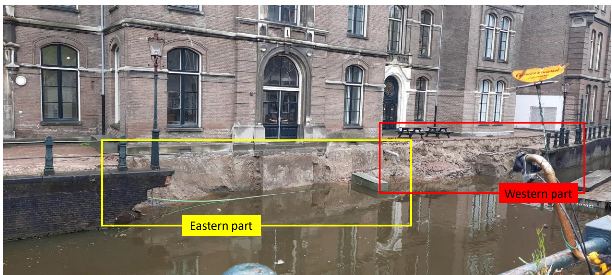
Figuur 3.11 Overzicht van de ingestorte kade in oostelijk en westelijk deel.
