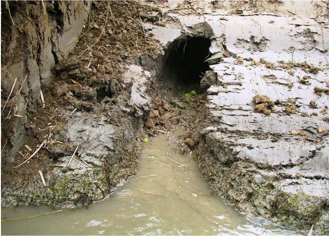
Figuur 3. Uitgegraven beverhol in het bermталud van de Ooyse Bandijk na graverij door bevers in 2004 (Foto muskusrattenbestrijding Gelderse Waterschappen).
