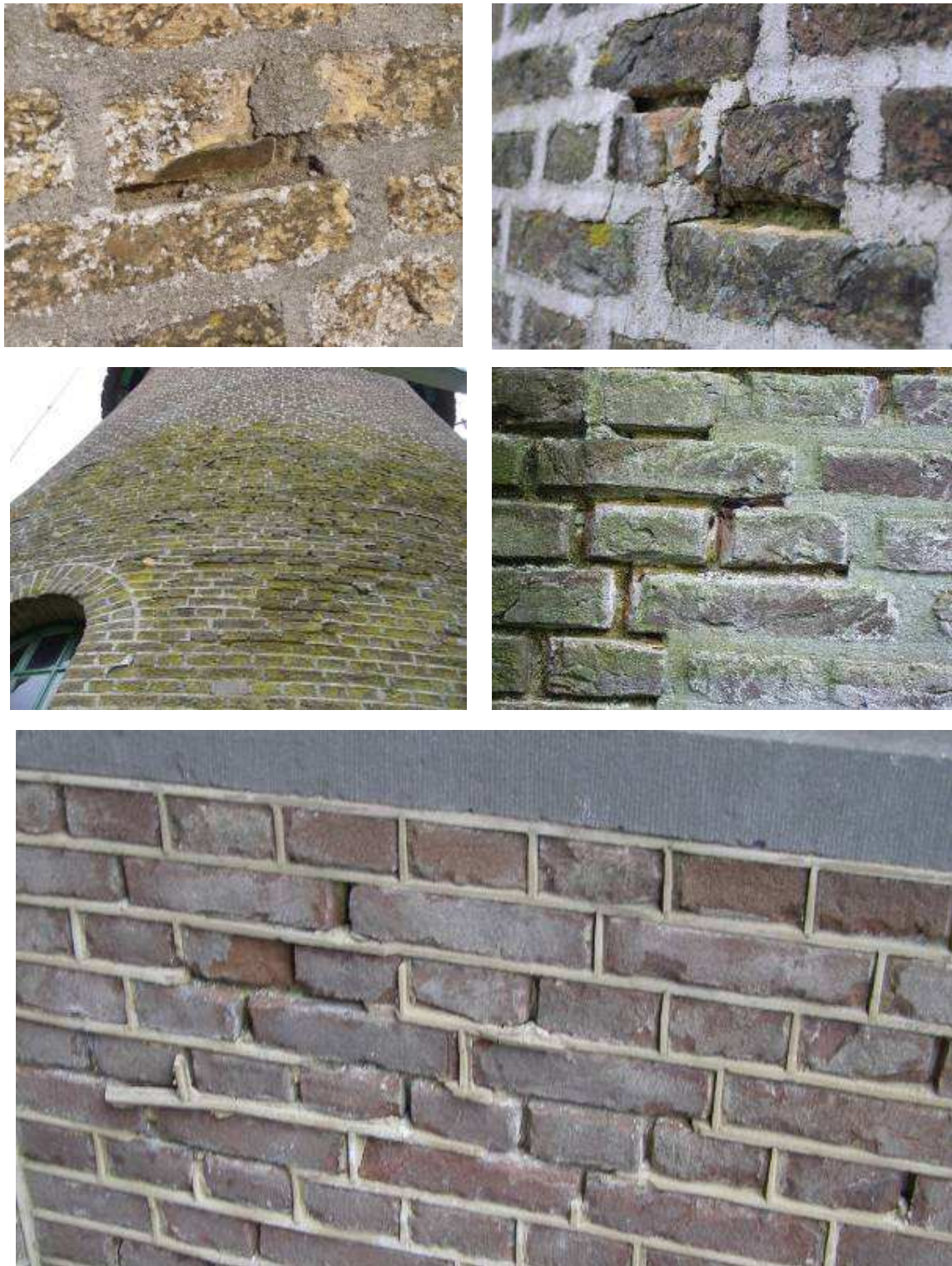
Figuur 3.1 Door grof, onvakbekwaam uithakwerk, grote schade aan de steenranden; niet terug te draaien; bovendien een niet compatibele mortel toegepast; gelukkig wel terug te draaien.
