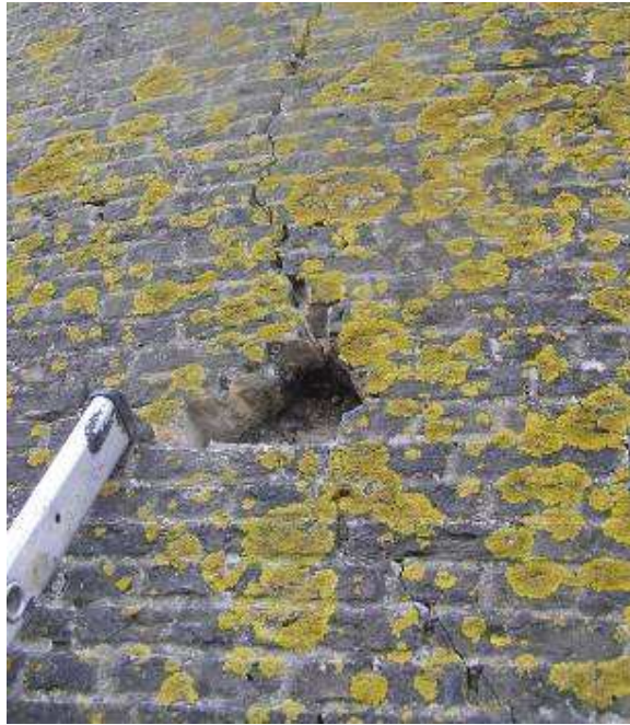
Fig. 1.2 Voorbeeld systeem A , molenromp. Authentiek werk in kalkmortel; inboetwerk cementmortel. Onthechting, scheurvorming, lekkage, verder losdrukken door vorstinwerking (inmiddels vervangen door C+ in natuurlijke hydraulische kalk)
