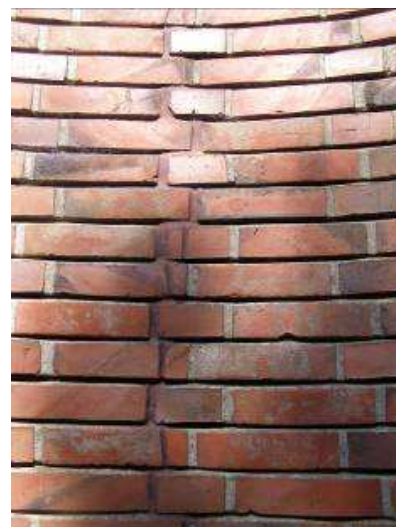
gepatineerde scheur SteenWatertoren Stadskanaal
