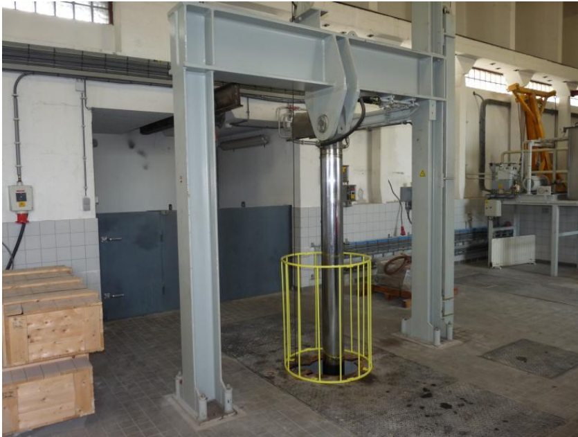
Figuur 7 – Hydraulisch cilinder ten behoeve van de rioolschuif
