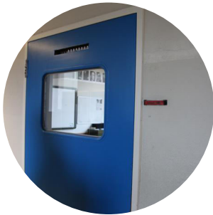
Ventilation grill door
