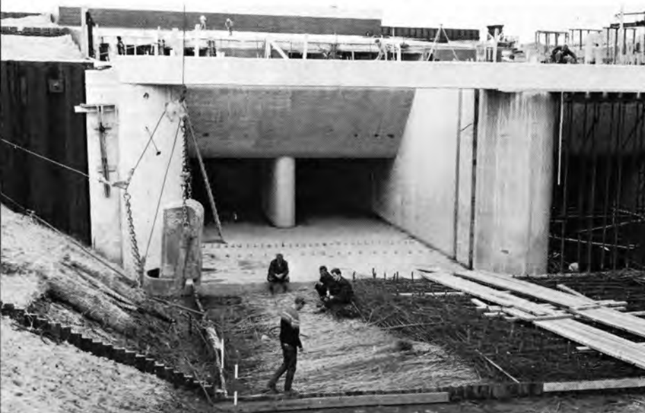
96. De toegangen tot de zuigkanalen hebben een schuin dak om het aanzuigen van lucht te voorkomen.
