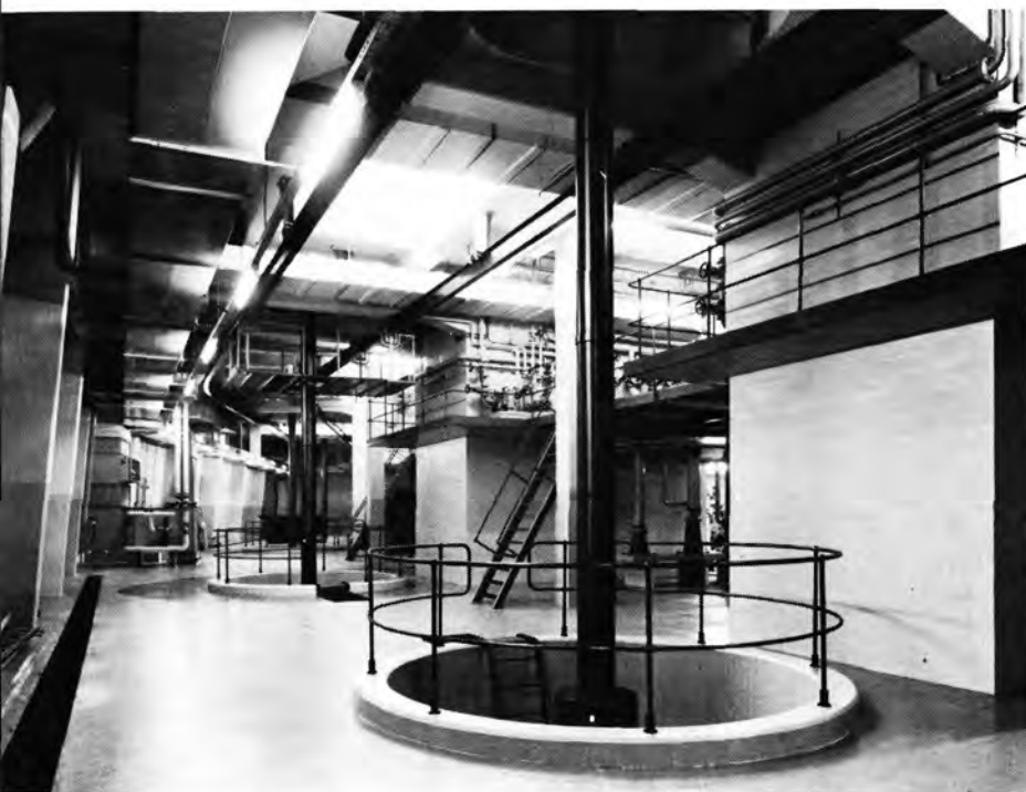
95. Pompkelder De Blocq van Kuffeler. De assen tussen de motoren ( boven ) en de waaiers van de pompen ( beneden ).
