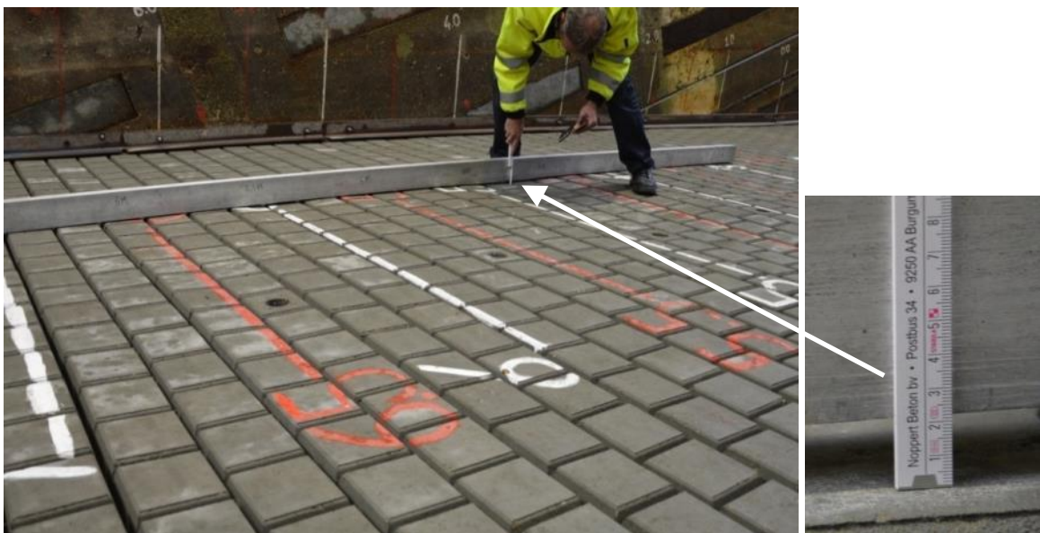
Figuur 4.10 Vervorming van het talud na proef V09
