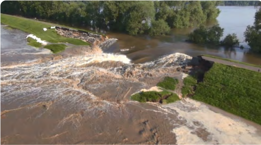
Dijkdoorbraak door instabiliteit binnentalud. Foto door Weichel (2013).
