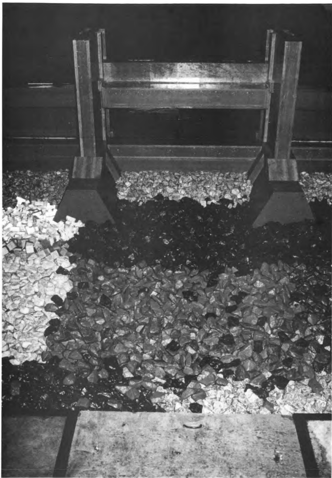
T245 Schade aan de toplaag van de drempel (basalt 6000 - 10.000 kg) tengevolge van een weigerende schuif (zie figuur 5.8.15)
