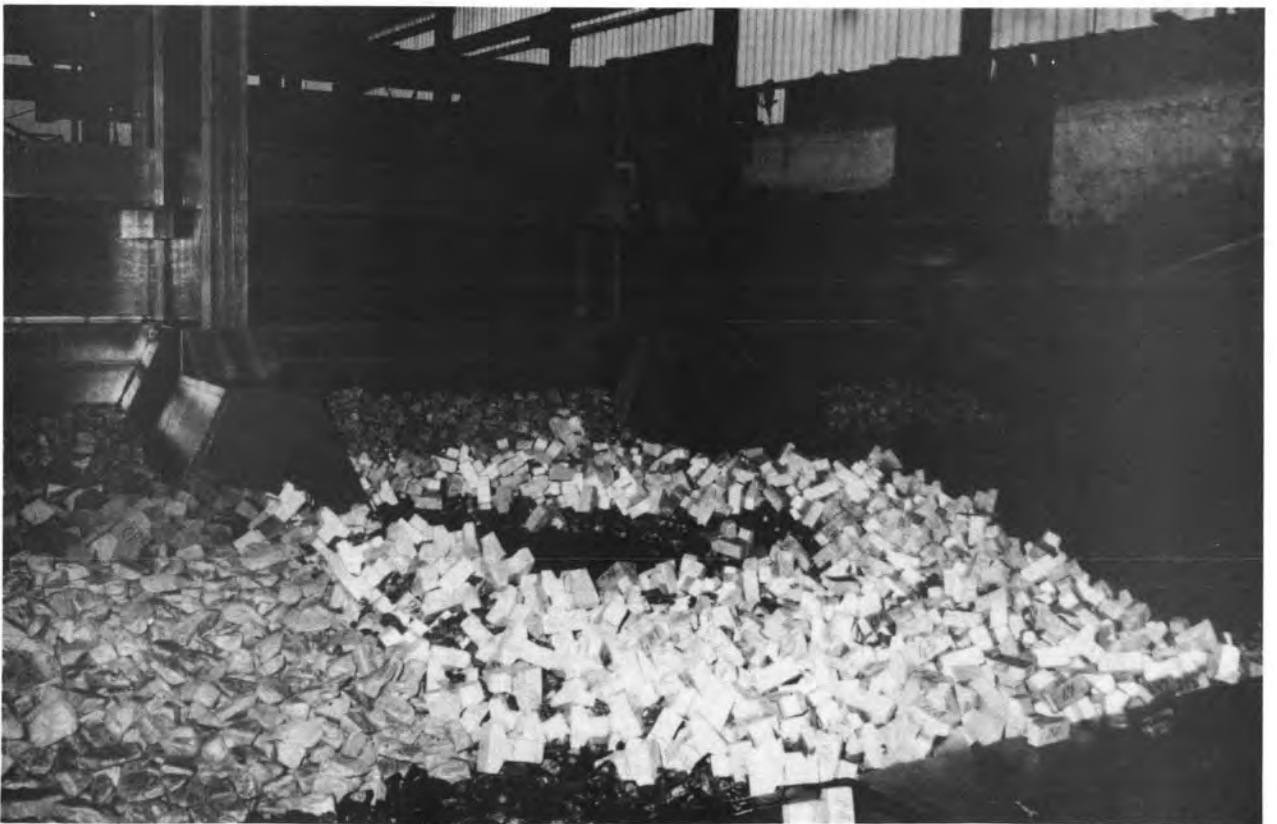
T243 Schade aan de toplaag van de drempel (akmons) tengevolge van een weigerende schuif (zie figuur 5.8.13)
