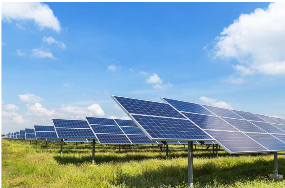
Figure 2: PV modules in the field; Illustration by: Gemeente Houten, accessed 30/10/2019, www.zonneveldenhouten.nl/zonnevelden/voorbeelden-zonnevelden/
