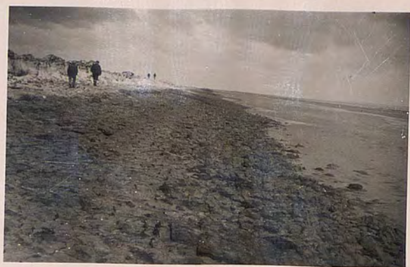
15. Idem. Buitentalud na storm. Alle zoden dood en weg. Bovendeel dijk vernield.
