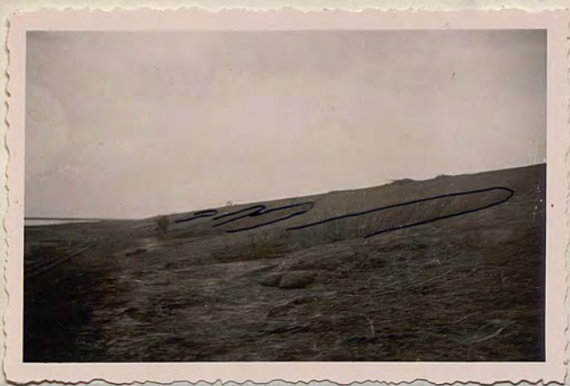
24. De Slikken. Gaten in buitentalud. Zoden weggespoeld.
