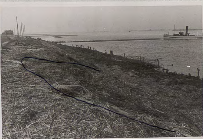
6. Een aanzienlijke wegzakking, gedeeltelijk wegspoeling. Wanneer niet zo veel veek aanwezig was geweest zouden de gaten nog groter geworden zijn.
