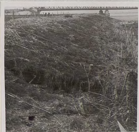
10. Spoelgat in buitentalud.
