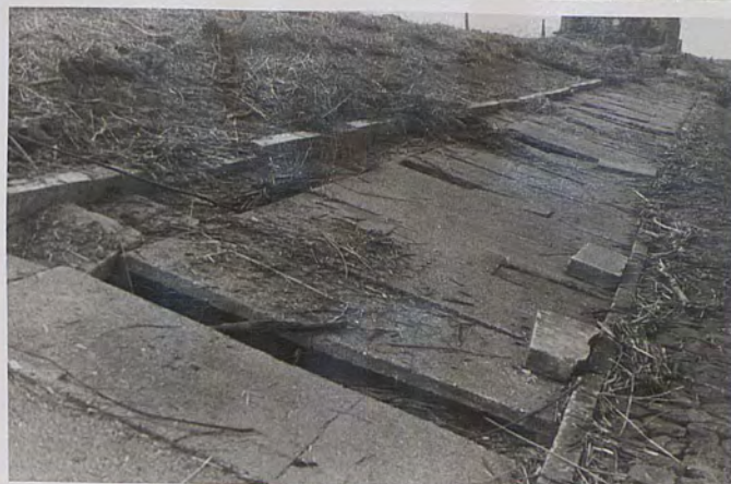
5. De betonplaten zijn als verdediging slecht. Veelal gebroken en onderspoeld. Reeds lang verwaarloosd.
