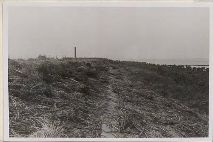
4. Buitentalud op 14 April. De betontegels hebben zich vrij goed gehouden.
