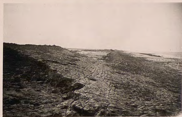
16. Idem. Buitentalud. Enkele resten van het bovendeele zijn blijven staan.
