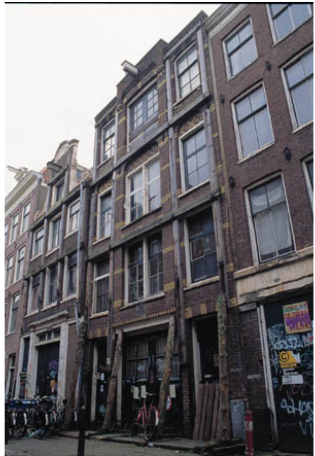
Door inklinking van de ondergrond ontstaat negatieve kleeft op de funderingspalen en zakken de palen en daarmee het pand. Door het ophogen van de wegen of werkzaamheden aan de kades zijn de palen onder de voorgevel meer gezakt dan de palen onder achterliggende delen, waardoor de panden naar voren hellen.
