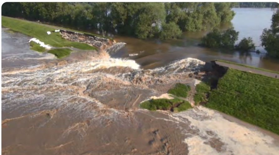
Dijkdoorbraak door instabiliteit binnentalud. Foto door Weichel (2013).
