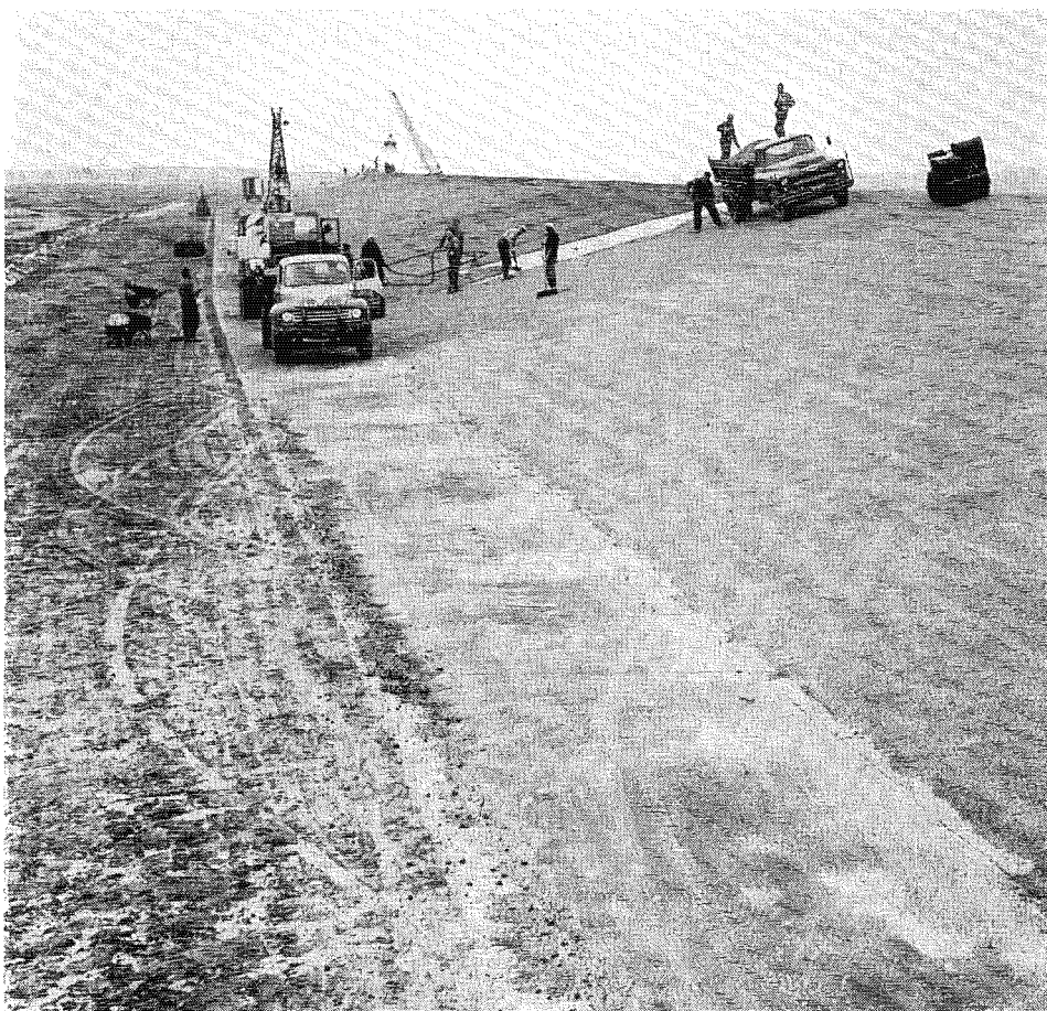
Het aanbrengen van de asfaltbekleding op het buitentalud van de verzwaarde zeedijk van de Banckspolder
