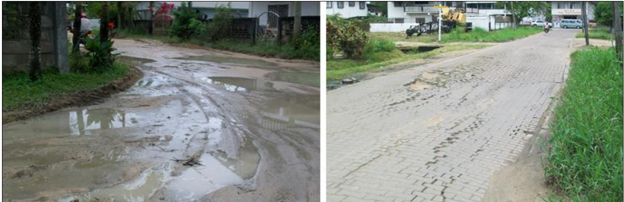
Figuur 46 Conditie zandwegen bij regenval en zeer slechte conditie betegelde weg
