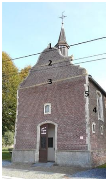
Fig. 2: Voorgevel van de kapel voor restauratie met aanduiding van de te restaureren elementen: opgevel (1), de bovenste waterlijst (2), de onderste waterlijst (3) de raamomlijstingen en de 15 statiekapelletjes (4) en de hoekblokken (5)
