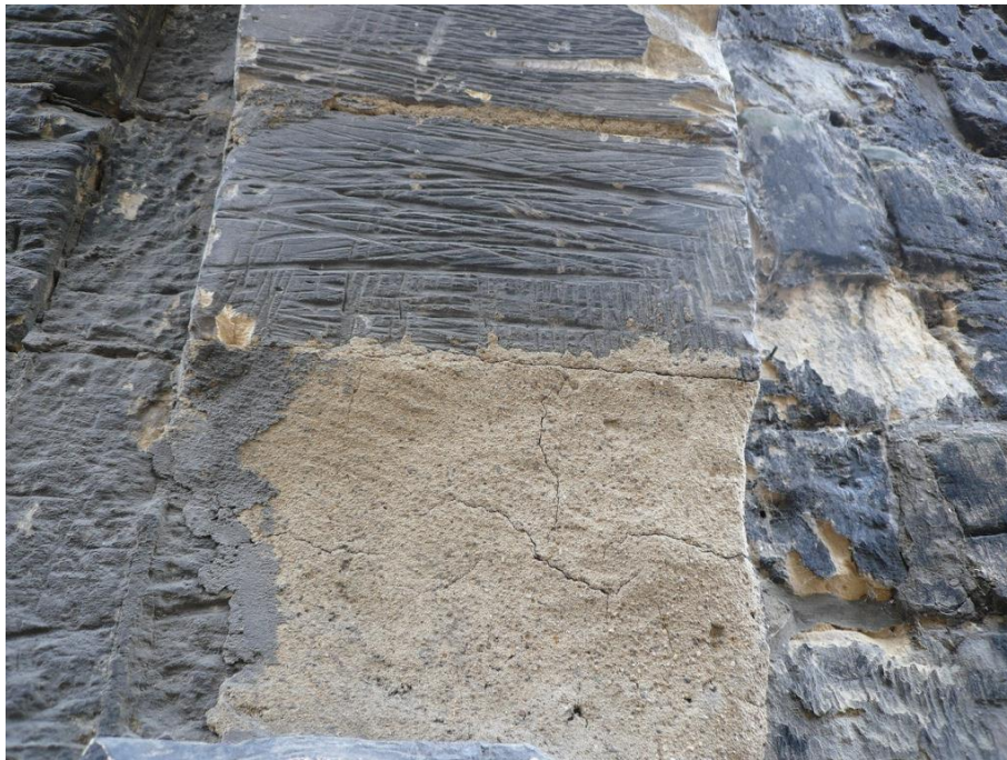
Fig. 6: Krimpscheuren in steenreparatiemortel
