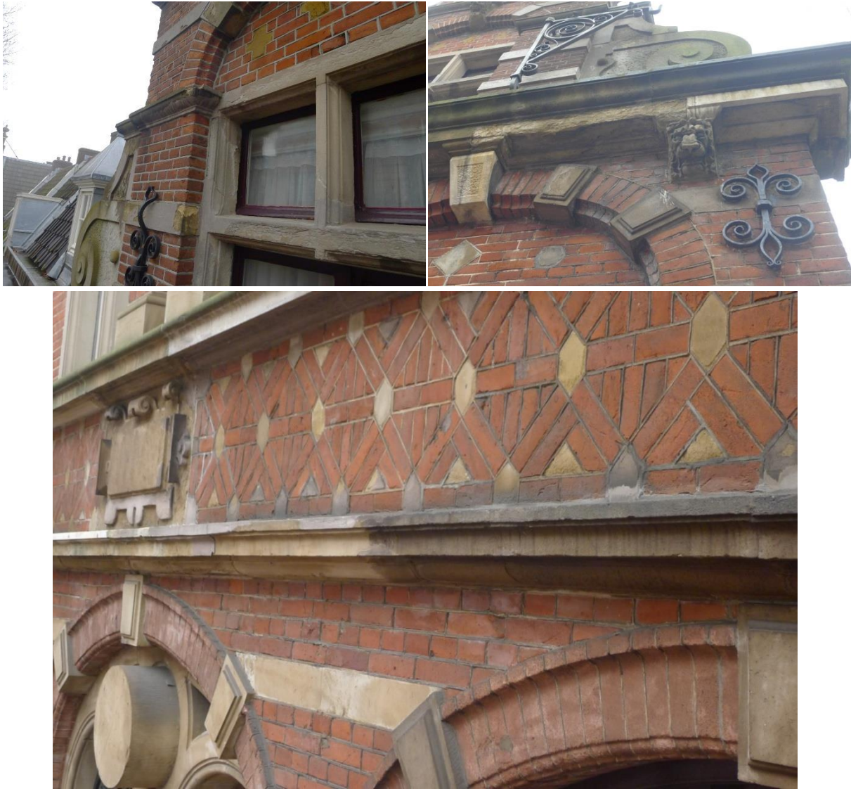
Natuurstenen waterlijst met oudere mortelreparaties
