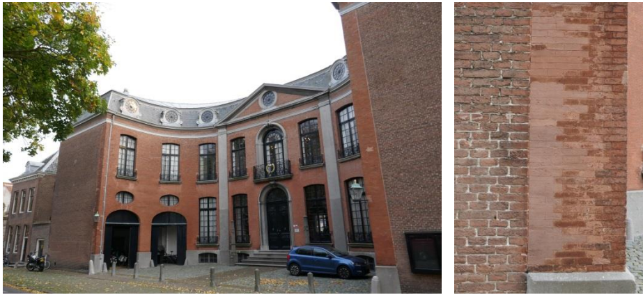
Fig. 2: Van de Perrehuis in Middelburg, gebouw 1765; de hol geslepen voorgevel met zeer fijn voegwerk is op diverse plekken hersteld met reparatiemortel
