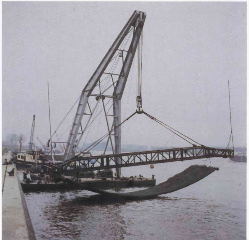
Figuur 11: Plaatsen van een asfalt- mat m.b.v. een hijsframe aan een drijvende bok
