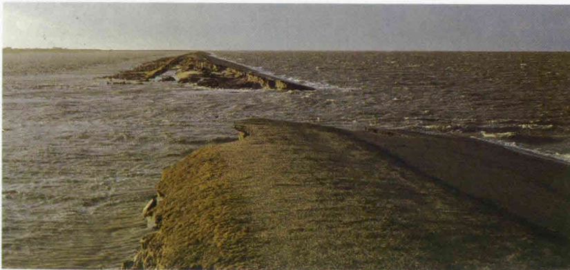
Figuur 4: Doorbraak zomerdijk als gevolg van onbereikbaarheid schadeplaatsen door groot materieel.
