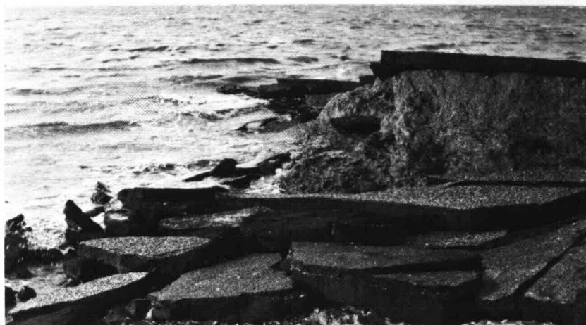
Figuur 5: Detail schadeplaats van met zandasfalt beklede zomer(klei)kade.
