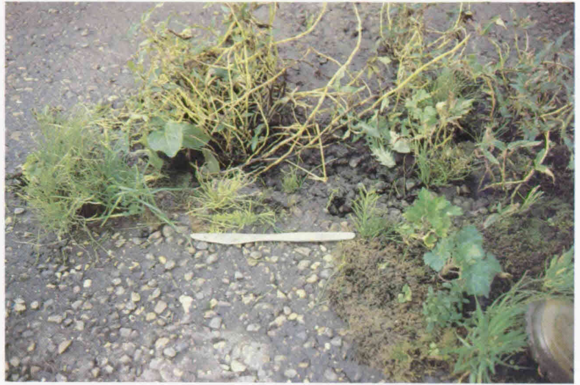
Figuur 4: Aantasting van een asfaltbetonbekleding door plantengroei
