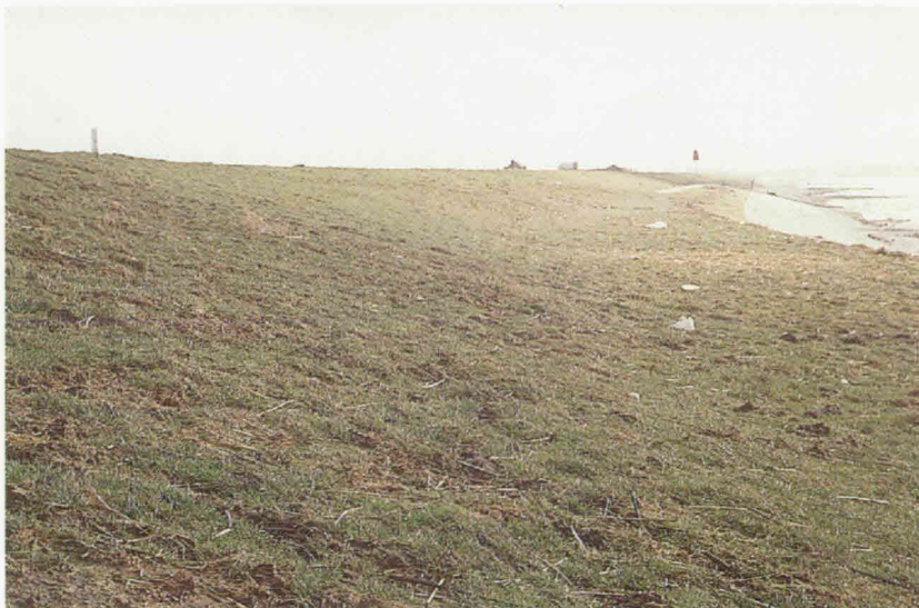
Dezelfde locatie na de februaristorm in 1990: de grasmat is over grote lengte aangetast tot NAP +6 m (hoogste waterstand hoogwater NAP + 5,04 m)
