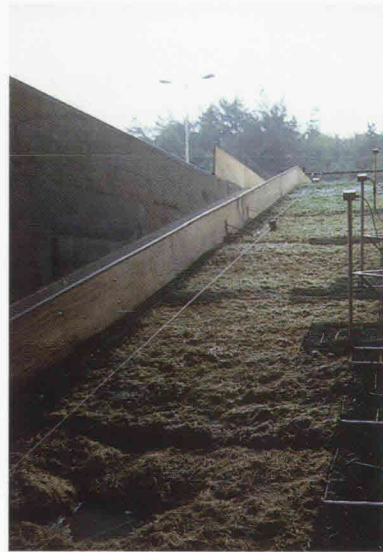
Door specifieke eigenschappen van het gras-kleicomplex heeft de bekleding 16 uur golven goed doorstaan
