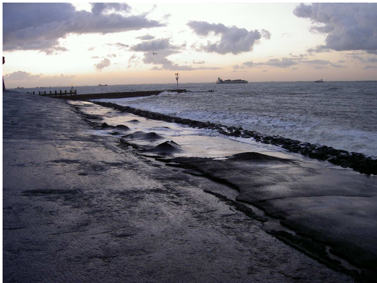
Foto 15.1: Schade door wateroverdruk
