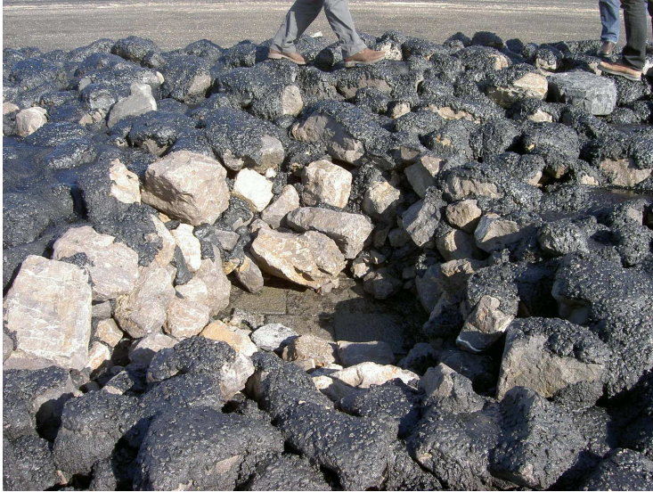
Foto 15.2: Schade door wateroverdruk in de vol en zat gepenetreerde breuksteenbekleding
