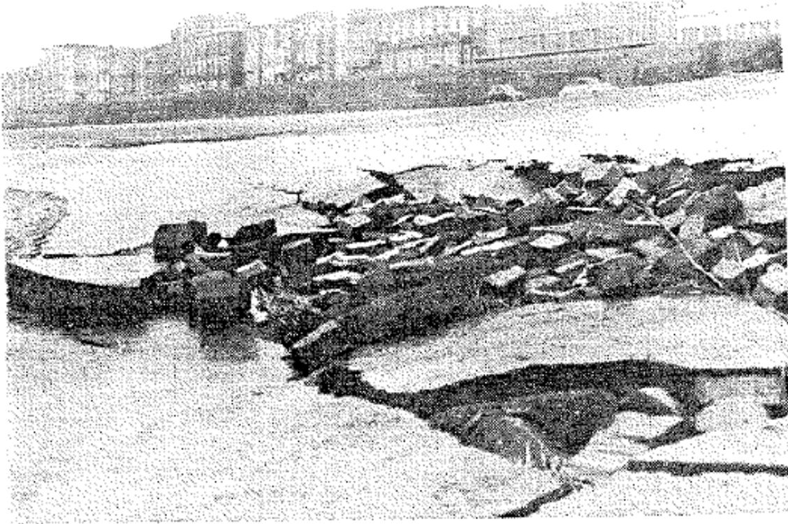
foto 7. Schade in januari 1960
