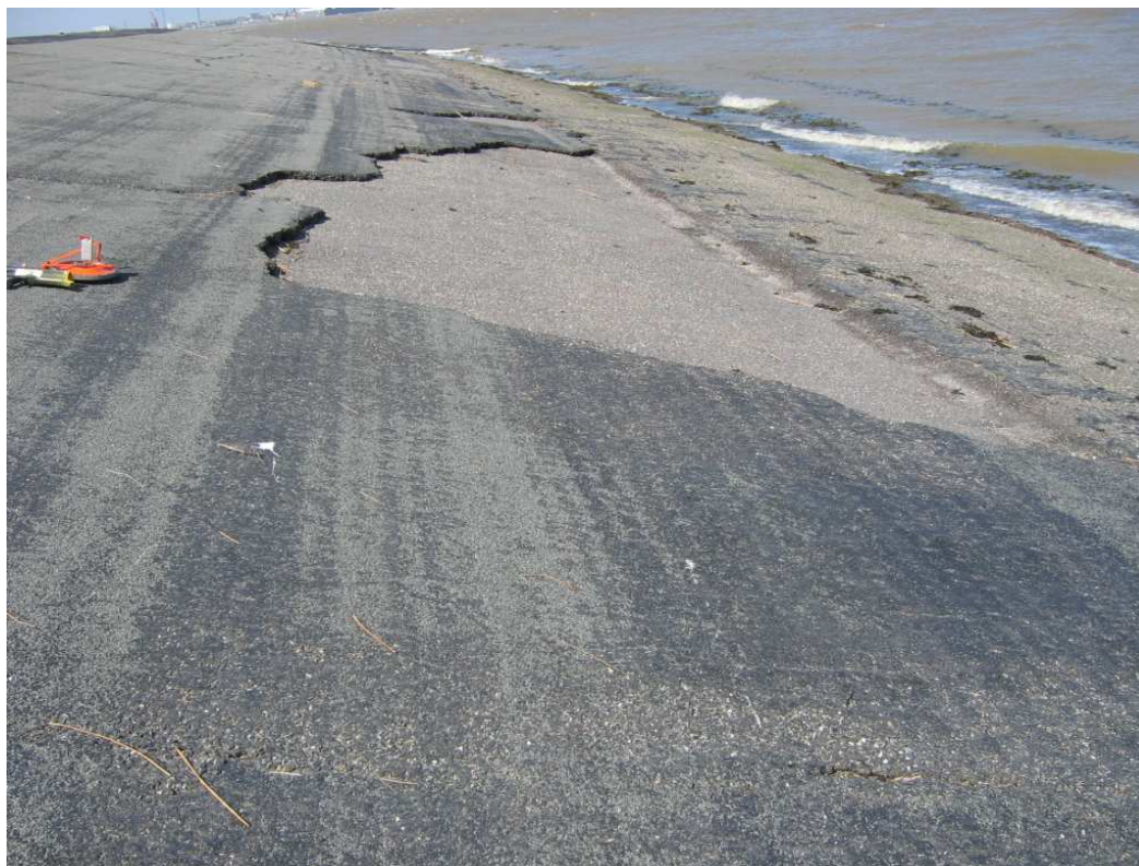
Foto 13.1: Schade strekdam te Delfzijl
