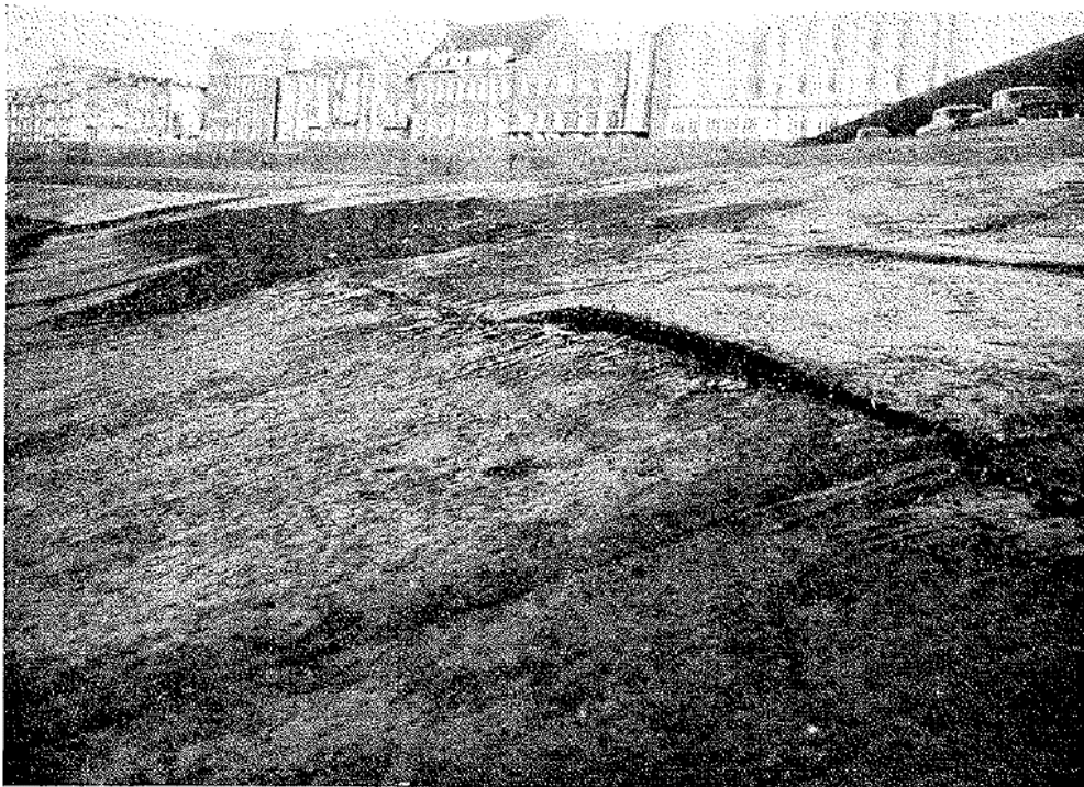
Afbeelding 17. Vlissingen. Golfbreker voor de Boulevard De Ruyter. Opbolling en scheuren t.g.v. voortplanting golfdruk
