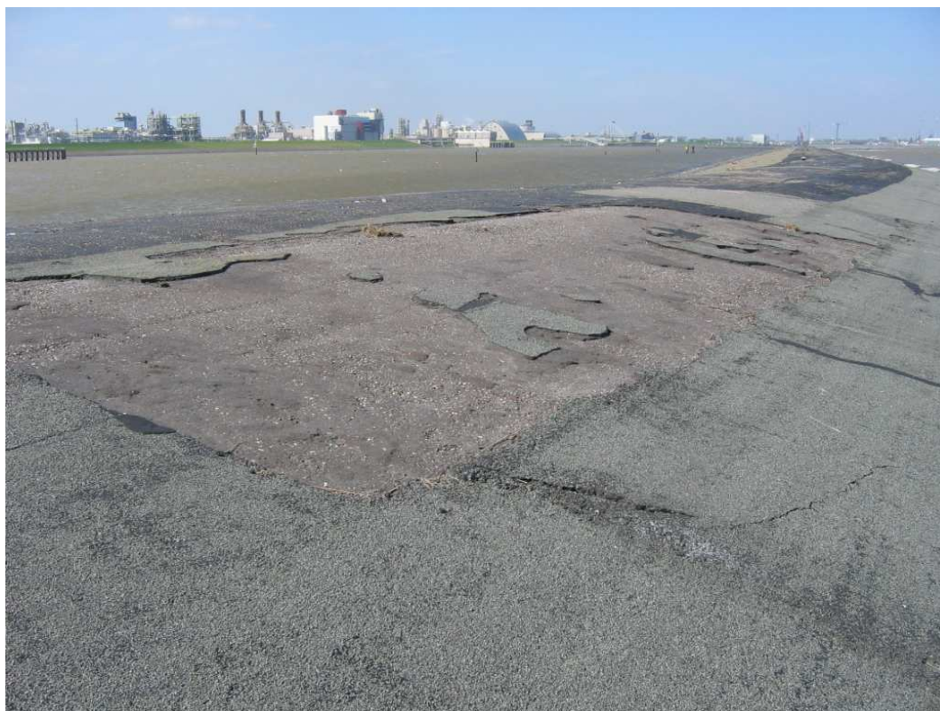
Foto 13.2: Schade strekdam te Delfzijl
