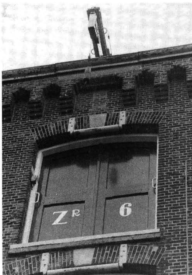
gaten in de gevel
