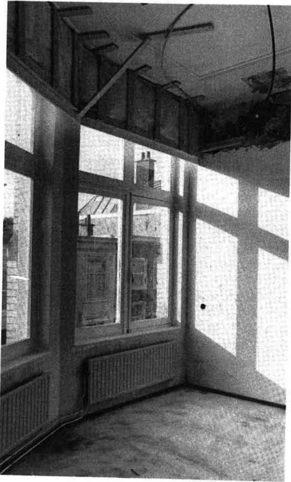
verlaagd plafond met lichtkoof
