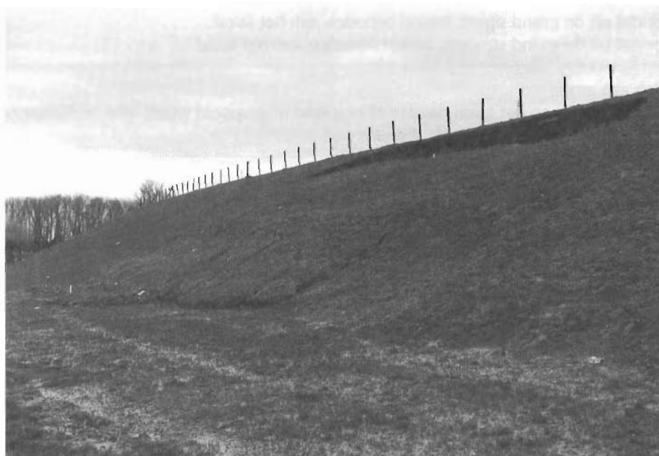
Bij een verschuiving van een moot grond boven aan de dijk, kan er onder aan de dijk grond omhoog gedrukt worden.
