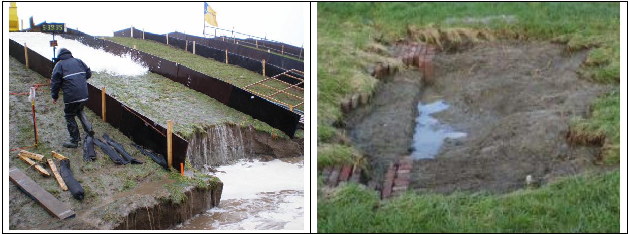
Foto 1 Schade bij overgang talud naar horizontale berm (rechter foto Boonweg: schade op horizontale deel tegen talud met aan linker zijde zichtbaar een oude klinkerbestrating onder de grasbekleding, en begin van schade op talud aan rechterzijde; linker foto Goese Sas: voortschrijdende afkalving talud, zogenaamde headcut erosie na initiële schade op horizontale deel); bron: SBW, 2008
