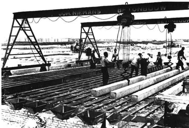
23 Heipalen voor woningbouw langs de Slotermeerlaan, Slotermeer, Amsterdam. Foto 1953. Foundation piles for housing construction on the Slotermeerlaan, Amsterdam.
