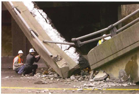
Figuur 12 Brug in de Verenigde Staten die is ingestort door breuk door corrosie van voorspanstaal (bron: internet)
