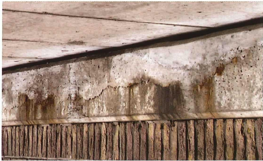
Figuur 15 Typische betonschade door chloride: roest bloeit uit, een eerdere reparatie komt er af en de wapening corrodeert weg
