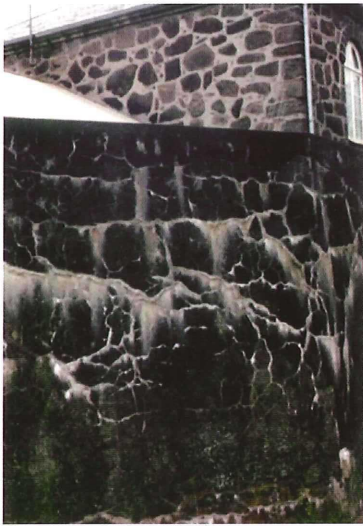
Figuur 5 Een door ASR aangetaste constructie, foto J. Larbi
