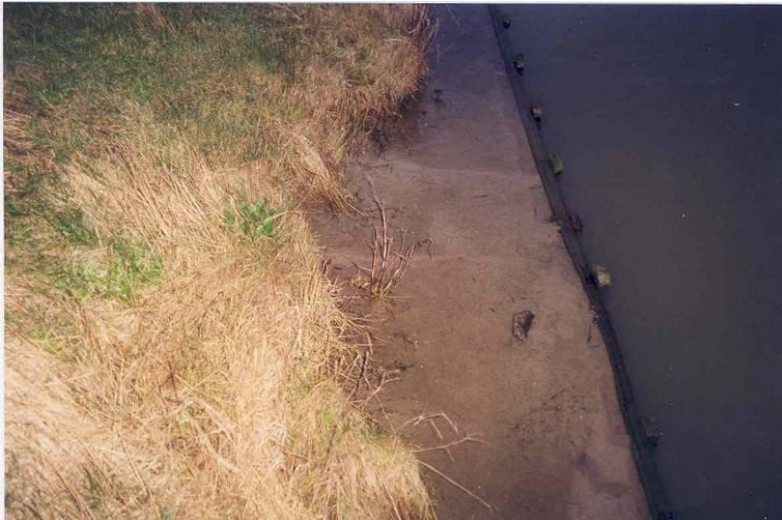
Figuur 3.1 Microinstabiliteit onder water, uitstromen van zand
