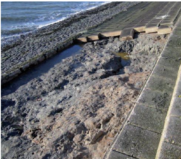
Figuur 3.2 Schade aan de steenzetting kwam vroeger veel voor maar leidde voor zover bekend nooit tot dijkdoorbraak
