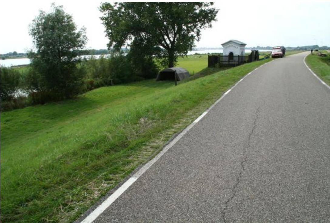
Figuur 2.15 Noordzijde Waaldijk bij Lingewaal bij TG346. Buitentalud gras. Weg op de kruin van de dijk. Bebouwing aan rivierzijde.
