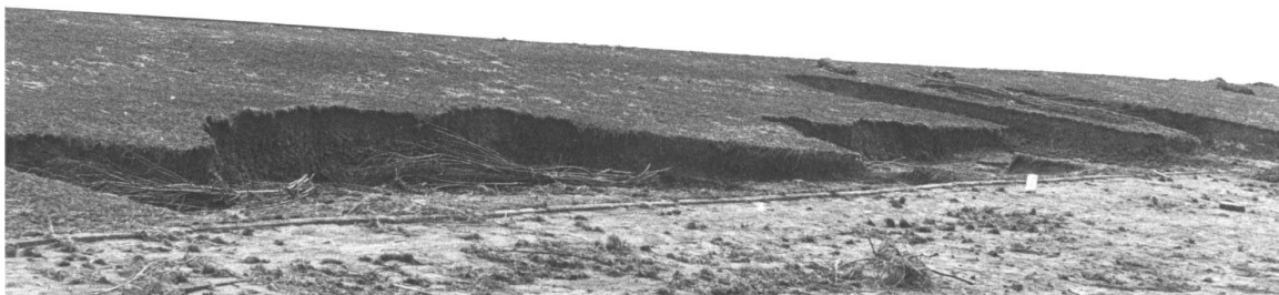
Figuur 3.15 Locatie met relatief veel spreiding in grootte van schade aan de Emmapolderdijk
