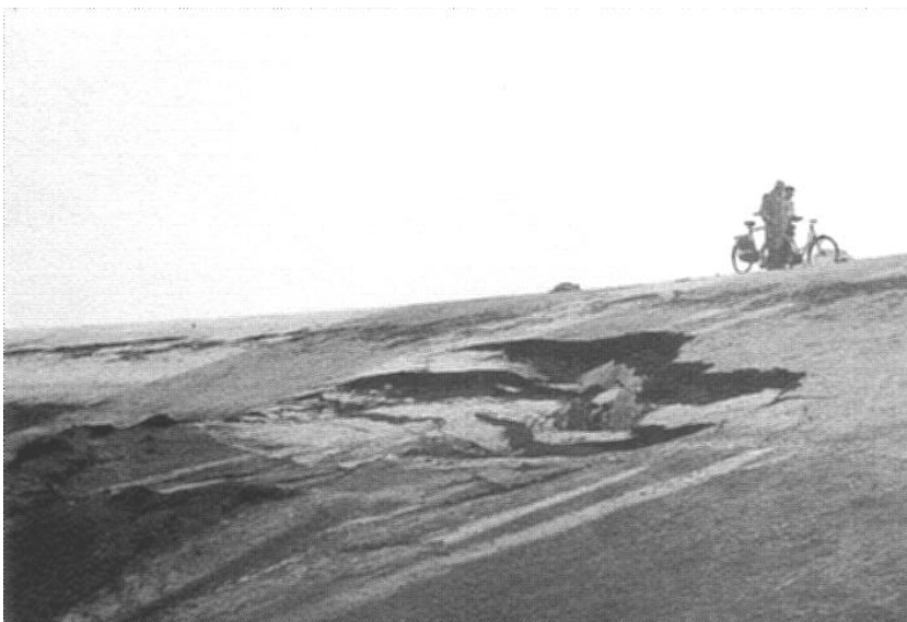
figuur 3.13 Nieuwe Veerhaven te Breskens: 8 cm asfaltbeton op 15 cm zandasfalt op klei: afgeschoven bekleding door wateroverspanning en verweking van de klei in de tijzone, 1958 (RWS 1990)
