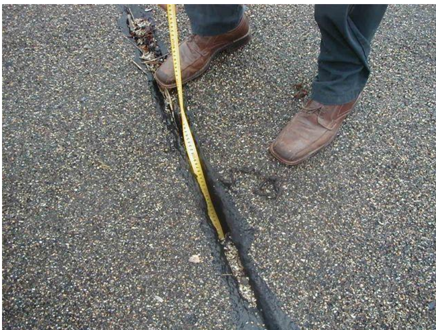
figuur 6.3 Inspectie van openstaande daglas op de Lauwersmeerdijk
