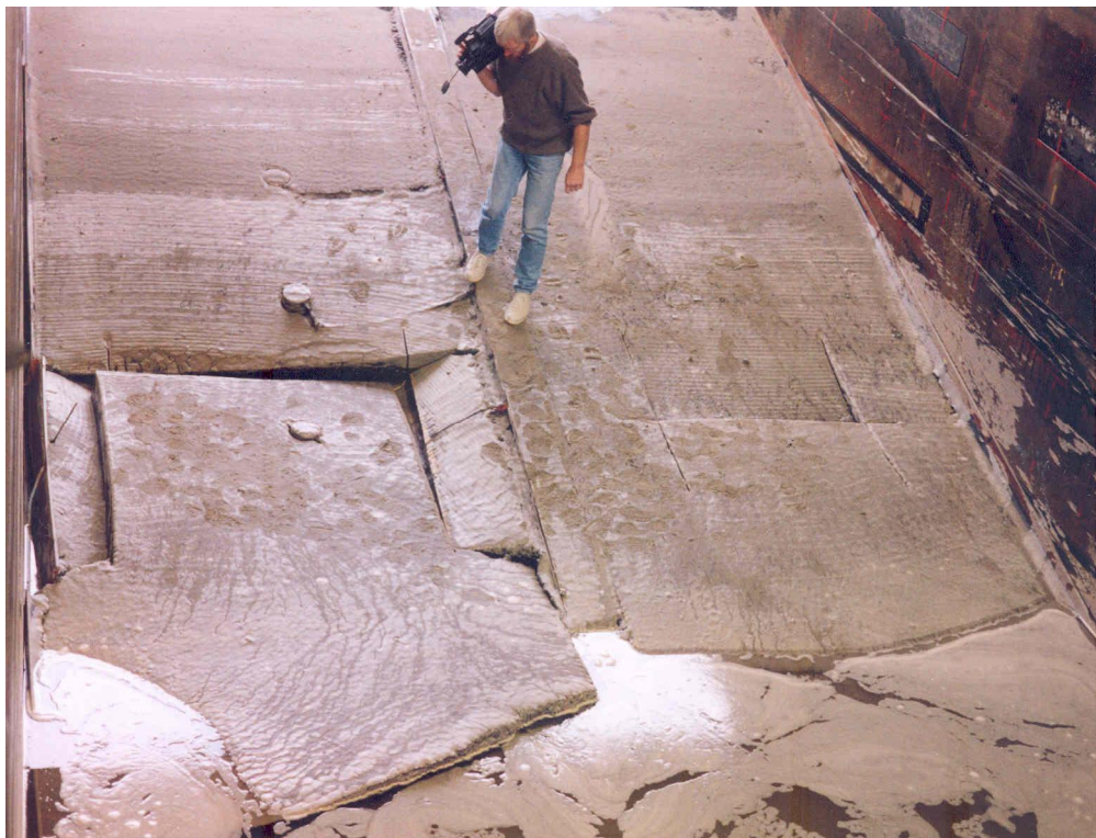
figuur 3.3 Schade na afbreken asfaltschol. De waterstand is verlaagd, zodat schade zichtbaar is.
