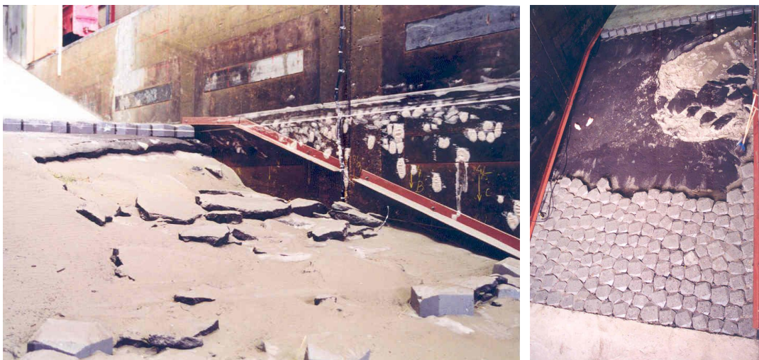
figuur 3.5 Schade aan zandasfaltonderlaag, links aanzicht vanaf ondertalud (voor het schoonspuiten) en rechts bovenaanzicht (na schoonspuiten)
