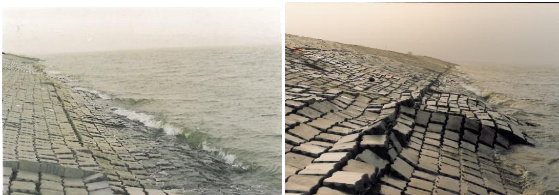
Figuur 3.9 Proefvak Armorflex (links) en Betomat op Houtribdijk (schade najaar 1986)
