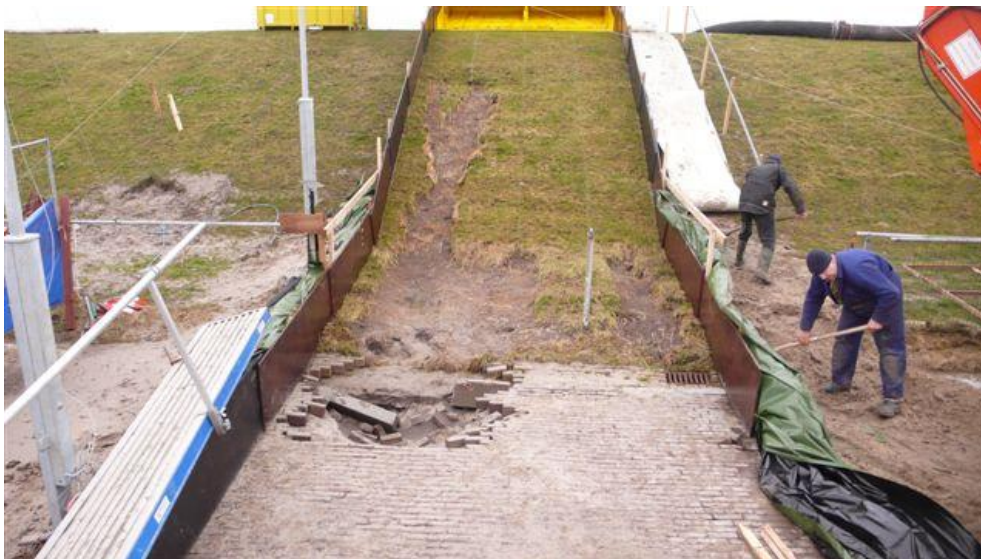
Figuur 3.4 Schade aan verharding bij teen van binnentalud bij golfoverslagproeven op de Afsluitdijk (2009)
