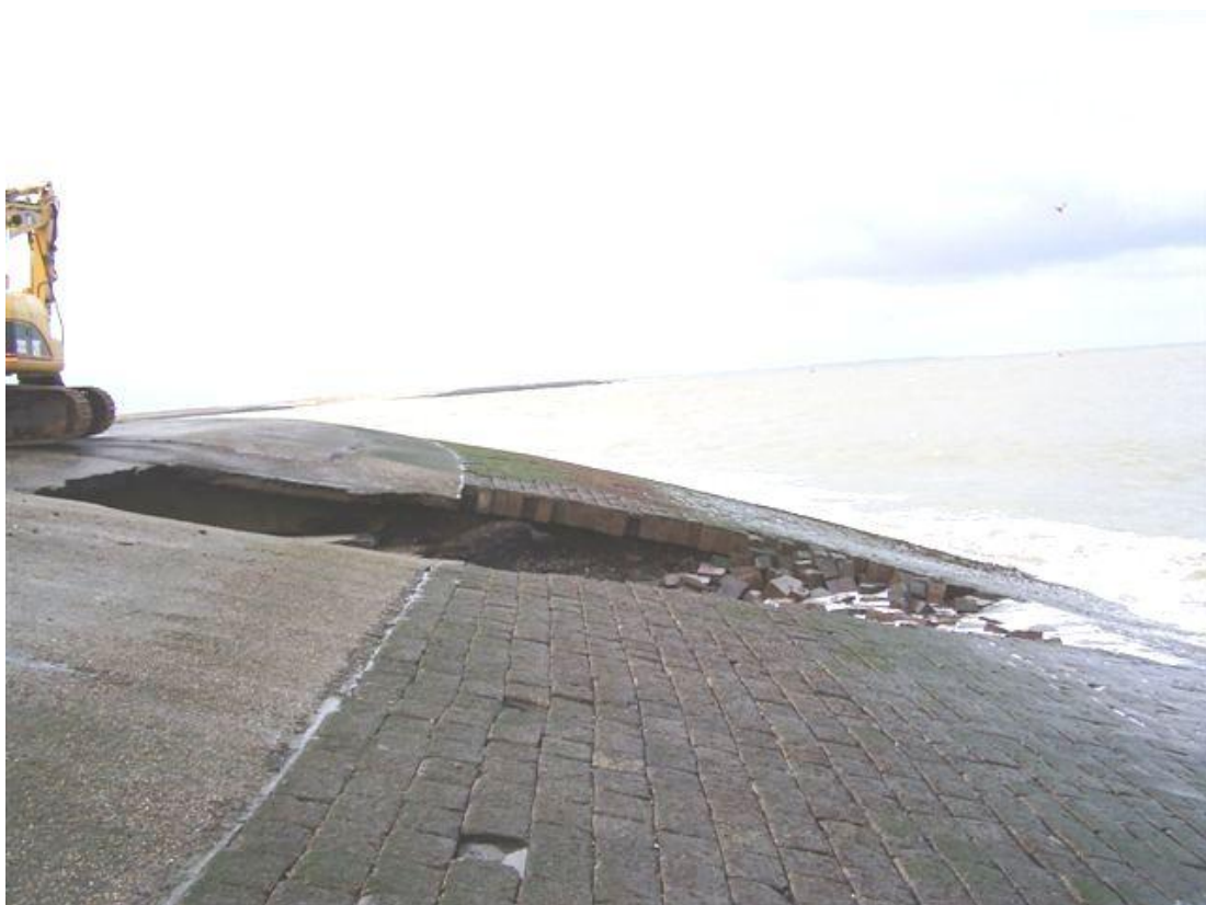
figuur B.1 Schade aan bekleding Roggeplaat Noordzezijde (P1240007)
