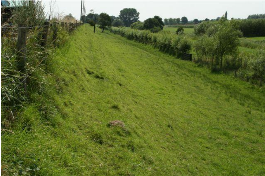
Figuur A.45 Noordzijde Diefdijk. Compartimenteringsdijk. "Binnenzijde" van de dijk. Zeer steil nabij de kruin.
