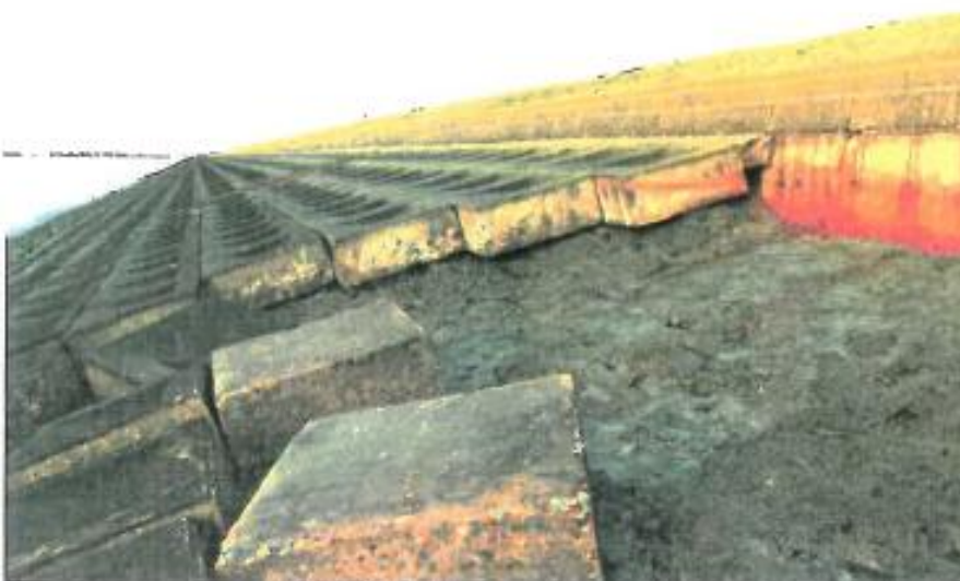
Figuur 3.4 Schade bij Scherpenisse
