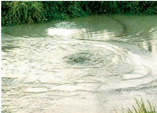
Figuur 3.4 Piping (zandmeevoerende wel) in binnendijkse sloot.
