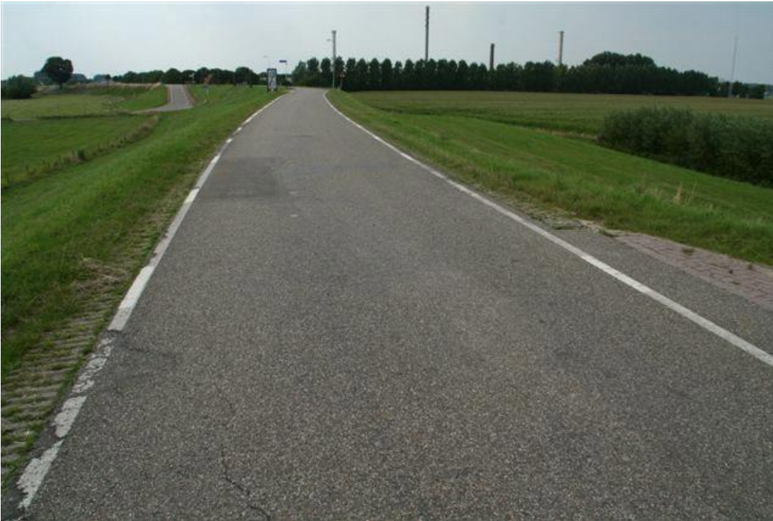
Figuur 2.14 Noordzijde Waaldijk bij Lingewaal. Buitentalud gras (links op foto). Weg op de kruin van de dijk. Verharde afrit aan rivierzijde, links-boven op de foto.
