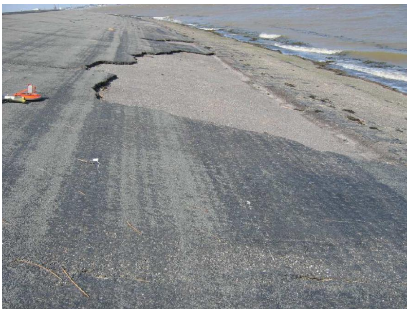
figuur 3.14 Schade strekdam Delfzijl in 2006: gebrekkige hechting tussen gefreesd vak en overlaging.
