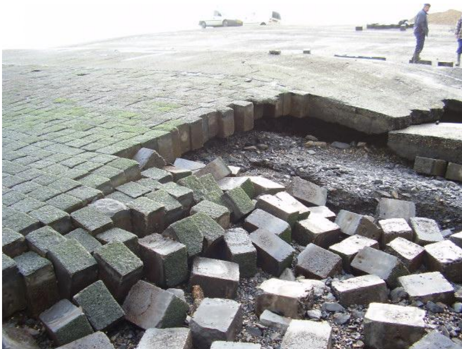
figuur B.6 Noordelijke rand schade Roggeplaat (P3220019)
