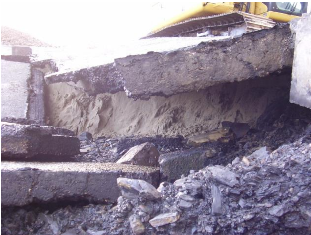
figuur B.3 Ondermijning zuidelijke rand van schade (P3220010)
