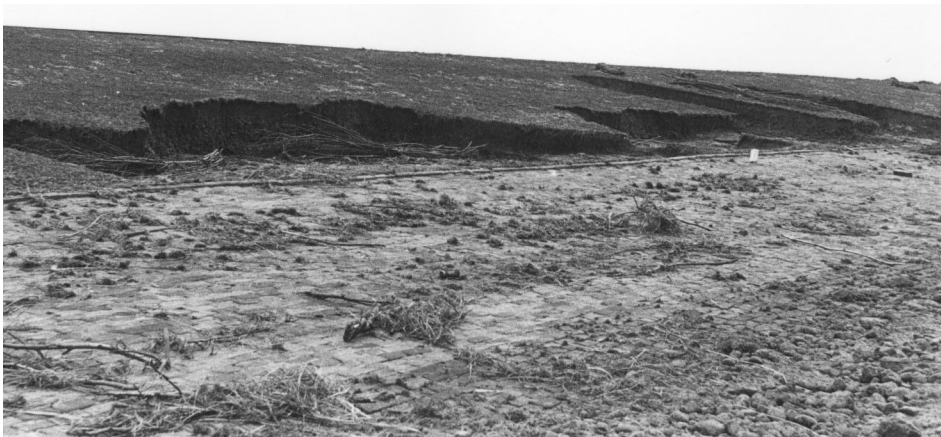
Figuur 3.6 Schade aan de Emmapolderdijk
