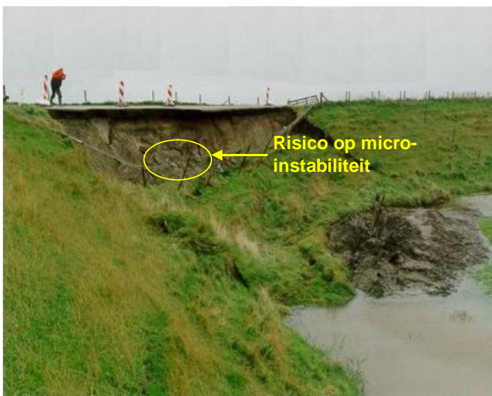
Figuur 4.1 Macro-instabiliteit binnenwaarts waarbij de kruin grotendeels op hoogte is gebleven, en micro-instabiliteit als vervolgmechanisme dreigt
