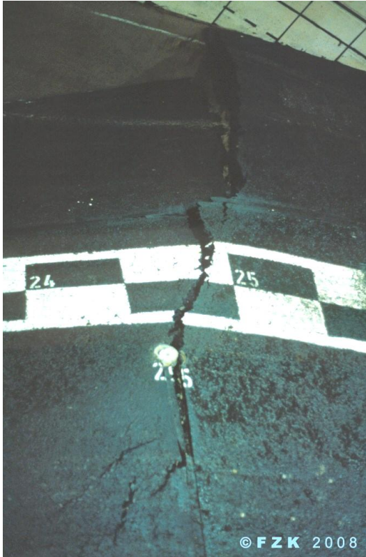
FZK, Versagen der Asphaltdecke, Bild 4
