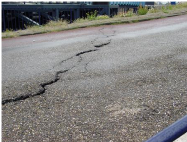
Figuur 3-14: Scheurvorming door verzakking damwand.
