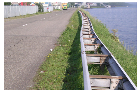
Figuur 2-8: Scheuren in wegdek t.g.v. verlaging bodem door erosie
