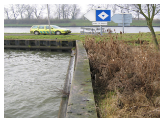
Figuur 2-7: Erosie achter damwand
